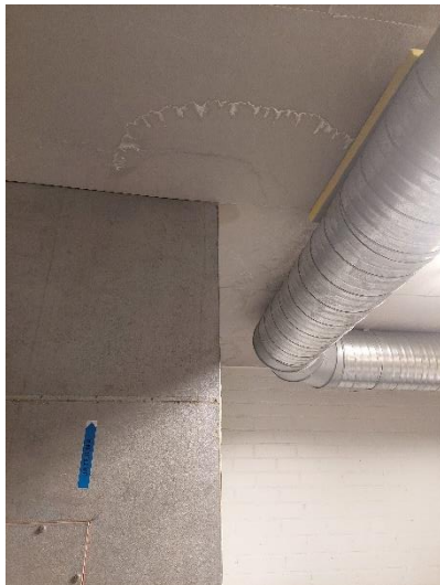
Kuva 72. IV-konehuoneen katossa todettiin vesivuotojälkiä läpiviennin kohdalla. Vesivuoto on aktiivinen.
