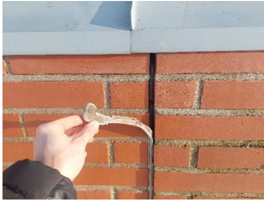
Kuvat 39a...c. Tiilijulkisivun elastisissa saumauksissa todettiin merkittäviä vesitiiveyspuutteita ja saumamassa on irti vastepinnoiltaan.
