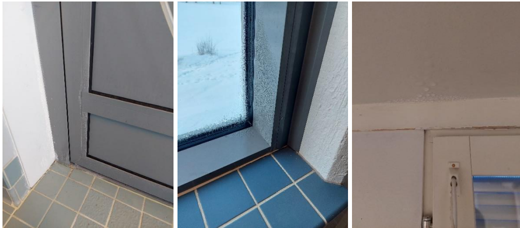
Kuvat 48a...c. Ovien ja ikkunoiden sisäpinnoilla sekä ulkoseinä-yläpohjaliittymissä todettiin monin paikoin kosteuden tiivistymistä.
