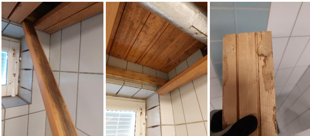
Kuvat 74a...c. Yleiskuvat yläpohjarakenteen vaurioista alueella, jossa todettiin kosteuskondenssia ja alhaisia pintalämpötiloja.
