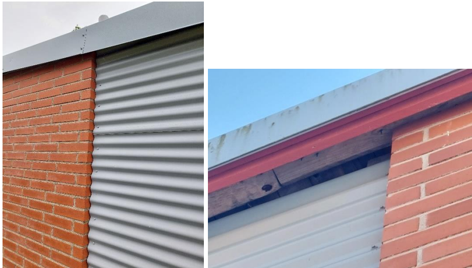
Kuva 42a ja b. Peltiverhouksen ja tiilimuurauksen liittymä (kuva a) ja räystäsliittymä (kuva b) on epätiivis. Liittymistä on suora yhteys ulkoseinän/yläpohjan eristetilaan.
