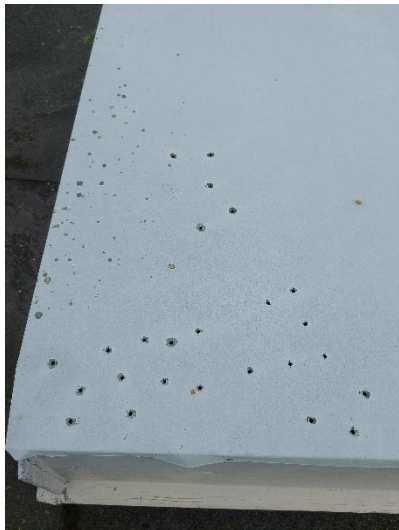
Kuva 62. Suojapellityksessä havaittiin reikiä.
