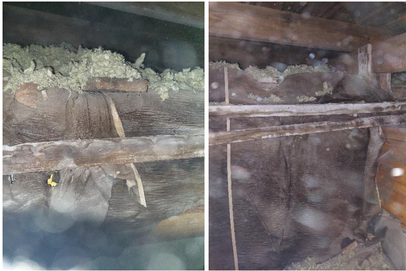
Kuvat 67a ja. Yleiskuvat yläpohjarakenteiden kosteusvaurioista.
