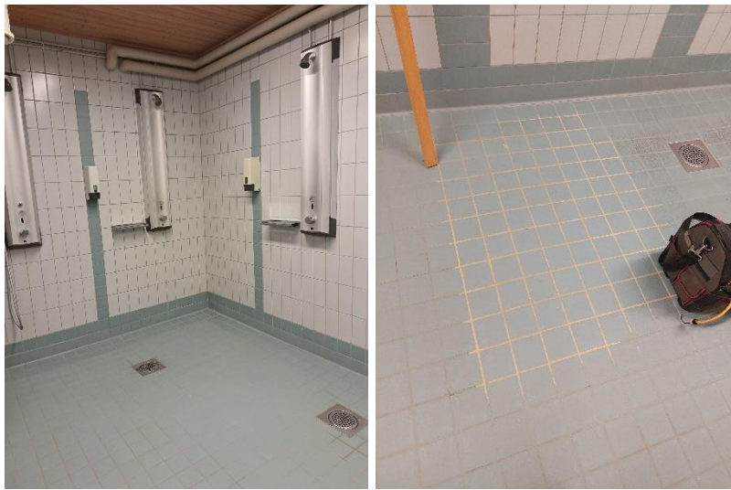
Kuvat 79a ja b. Yleiskuva märkätilasta. Seinät ja lattiat ovat laatoitettuja. Paikoin keraamisten laattojen saumoja on uusittu (kuva b). Lisäksi miesten pesutilojen lattia-laatoissa todettiin kopoa roiskevesialueella.
