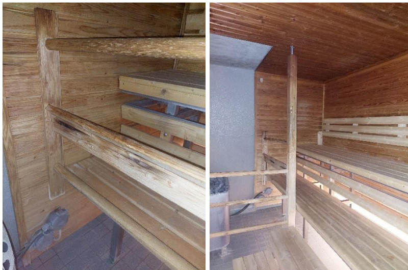
Kuvat 82a ja b. Yleiskuvat saunan pintarakenteista. Paneloinneissa, lauteissa ja kaiteissa todettiin tummentumia ja halkeilua.
