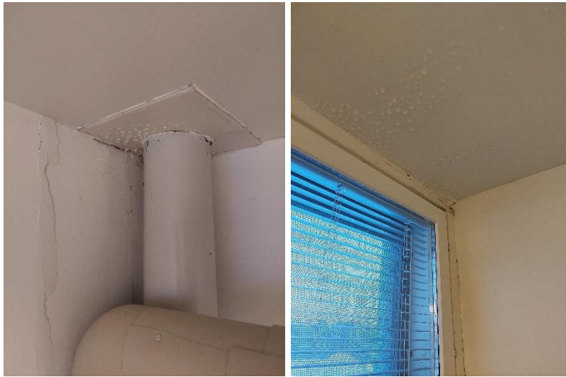
Kuvat 73a ja b. Yläpohjaliittymissä todettiin monin paikoin kosteuden tiivistymistä ja alhaisia pintalämpötiloja (kts. liite 2).
