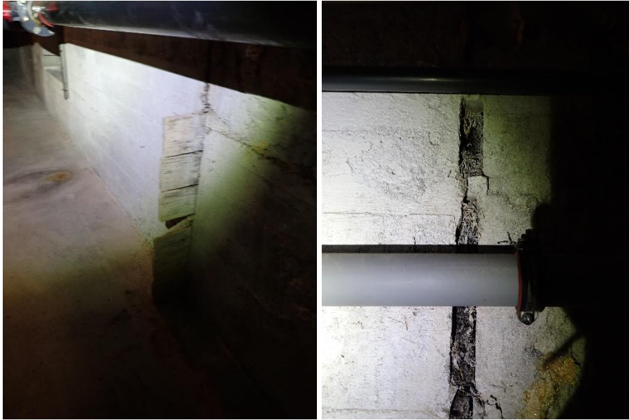
Kuvat 14a ja b. Laajennusosan ja vanhan osan välisessä saumakohdassa havaittiin orgaanisia rakennusmateriaaleja.
