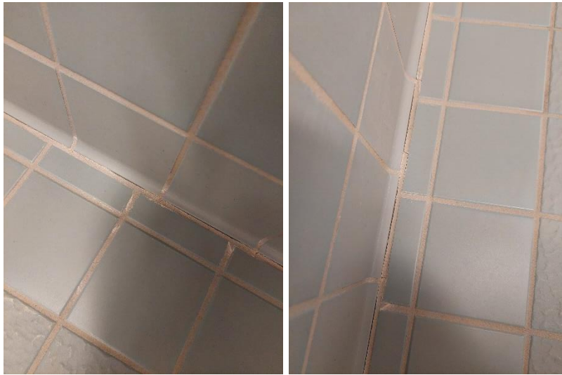
Kuvat 81a ja b. Pesutilojen laattasaumat ovat pääosin hyvässä kunnossa, mutta paikoin saumoissa esiintyy halkeamia/lohkeamia.
