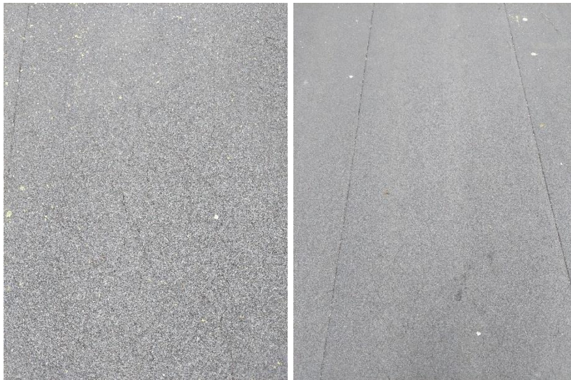
Kuva 56. Alkuperäisen rakennuksen osan bitumikermeissä havaittiin verkkomaista halkeilua.
