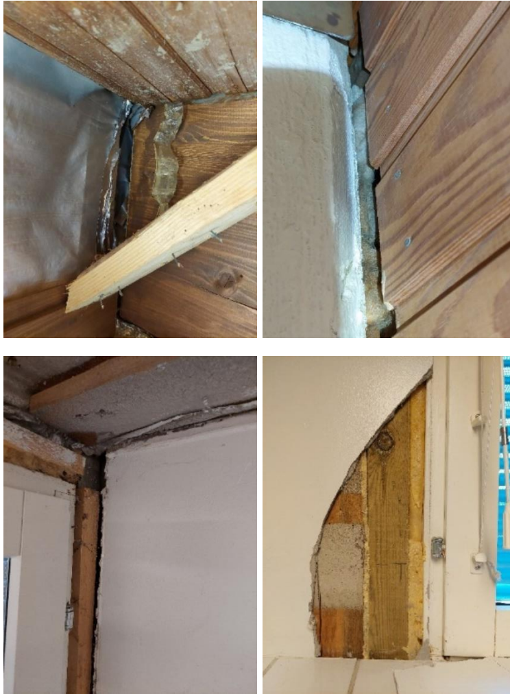
Kuvat 51a...d. Ulkoseinän rakenneliittymissä havaittiin järjestelmällisiä puutteita: kuva a=ulkoseinän höyrynsulun liittymä yläpohjapalkkiin (liitos epätiivis), kuva b=höyrynsulun liitos betonipilariin (liitos epätiivis), kuva c=ikkunan liittymä tiiliseinään (liitos epätiivis), kuva d=ikkunavälistä puuttuu höyrynsulku.
