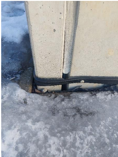
Kuva 44. Laajennusosalla sokkelin elastinen saumaus ei jatku yhtenäisenä alas asti. Kuvassa on havaittavissa maanvastaisen seinän ulkopuolisen vedeneristyksen repeäminen kiinnityksestään maanpinnan painumisen vuoksi.
