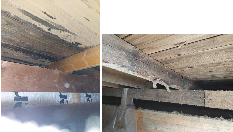
Kuvat 66a ja b. Esimerkkikuvat vesikatteen aluslaudoituksessa ja kantavissa rakenteissa havaitusta tummentumista. Puukolla arvioitaessa rakenteissa ei havaittu lahoa tai viitteitä pehmenemisestä.
