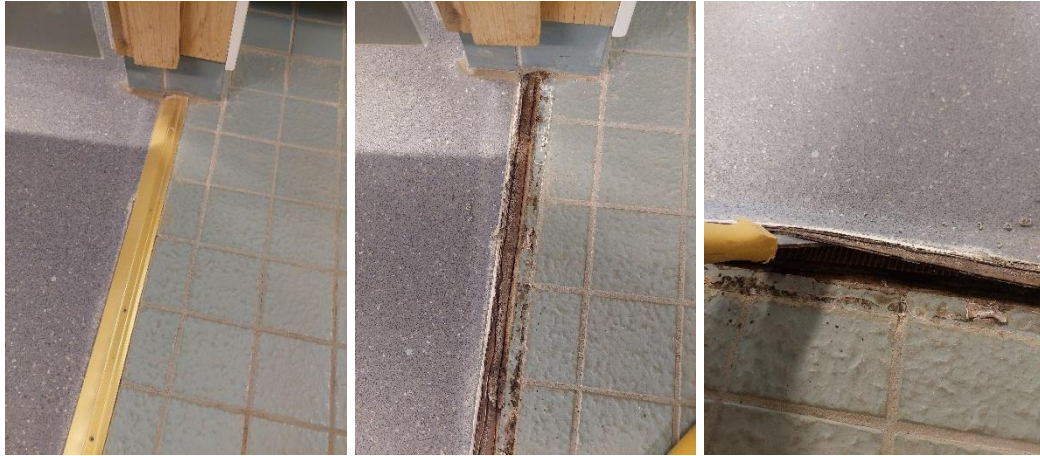
Kuvat 18a...c. Miesten pukuhuoneessa pesuhuoneen kynnyksen vierustalla todettiin kohonneita pintakosteusilmaisimen lukemia. Kynnyspellin irrottamisen yhteydessä todettiin, että keraamisen laatan ja muovimaton väliin jää rako. Muovimatto oli irti alustastaan ja liittymässä sekä muovimaton alapuolella todettiin mikrobivaurioita. Muovimaton alapuolella todettiin voimakas mikrobiperäinen haju.
