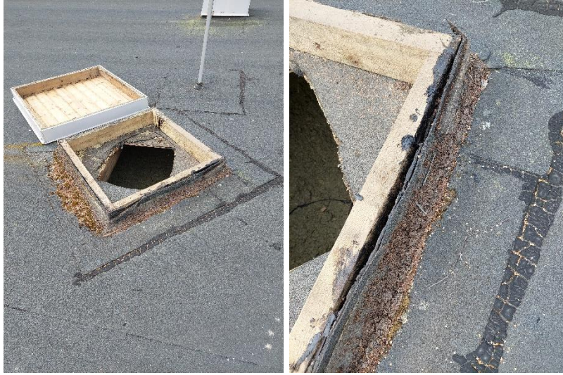
Kuvat 57a ja b. Kattoluukun ylösnostoston kohdalla bitumikermi on irti alustastaan ja liittymässä on merkittäviä vesitiiveyspuutteita.
