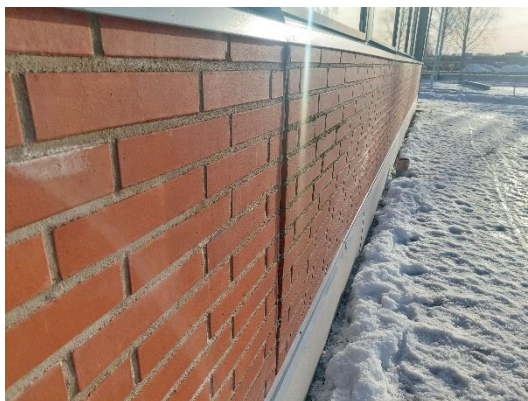
Kuva 40. Tiilijulkisivussa havaittiin pykältämistä takapihan puolella. Tiiliverhousta työntämällä todettiin muurauksen heiluvan lähes koko julkisivun laajuudelta. Samankaltaisia puutteita todettiin etupihan julkisivulla.
