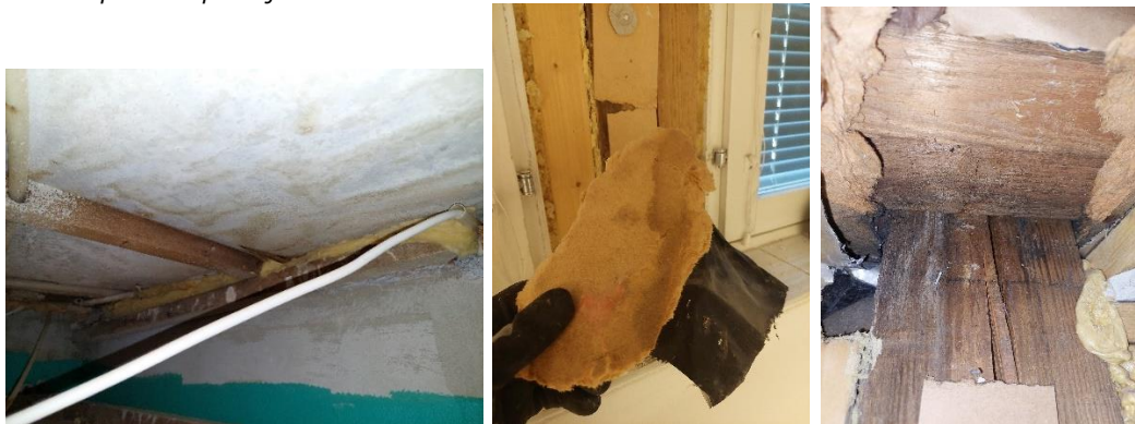
Kuvat 75a...c. Yleiskuvat yläpohjarakenteen vaurioista.
