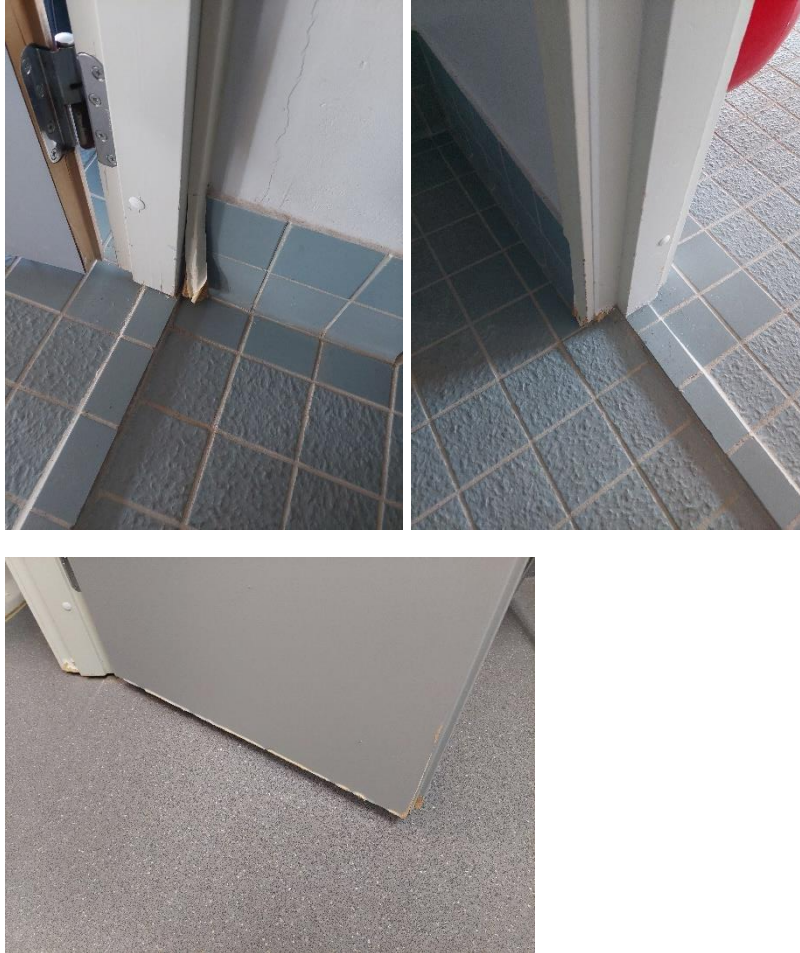
Kuvat 83a..c. Yleiskuvat pesutilojen yhteydessä olevien wc-tilojen ovista ja karmeista. Ovissa ja peitelistoissa havaittiin monin paikoin kosteuden aiheuttamia jälkiä.
