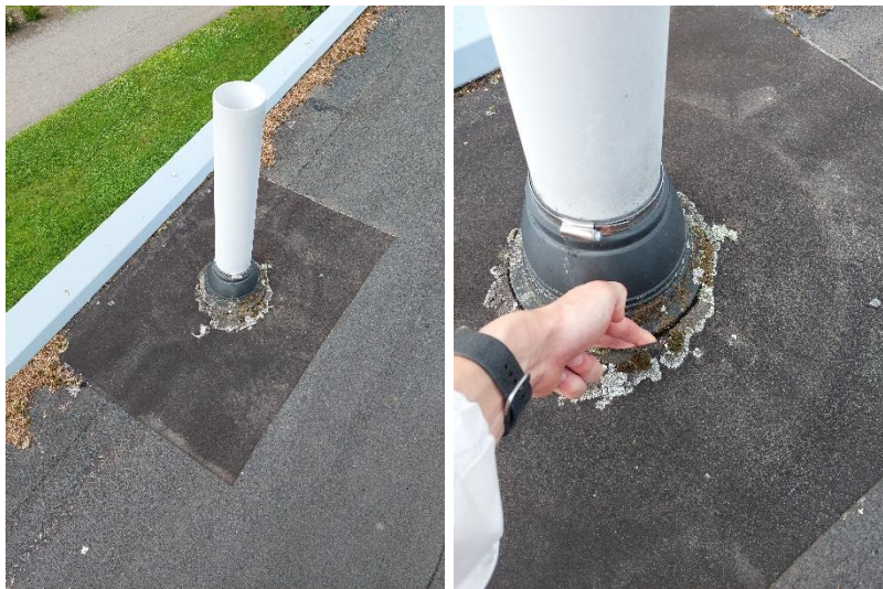
Kuvat 60a ja b. Viemärien tuuletusputkien läpivientien kohdilla vesikatetta on monin paikoin paikkakorjattu. Liittymien kohdalla kermi on irti alustastaan ja liittymissä on vesitiiveyspuutteita.
