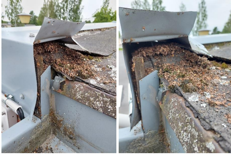
Kuvat 59a ja b. Miesten pukuhuoneen kohdalla räystääliittymässä todettiin vesitiiveyspuutteita. Kiinteistön käyttäjien mukaan kyseisellä kohdalla on todettu kattovuotoja rankkasateilla.
