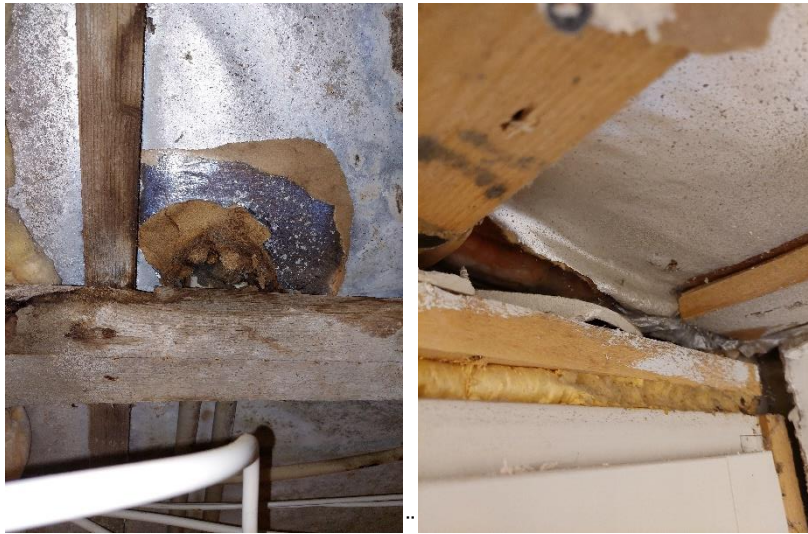
Kuvat 76a ja b. Esimerkkikuvat yläpohjarakenteen alumiinipaperin ilmatiiveyspuutteista. Kuva a= miesten wc-tila, kuva b= miesten pukuhuone.
