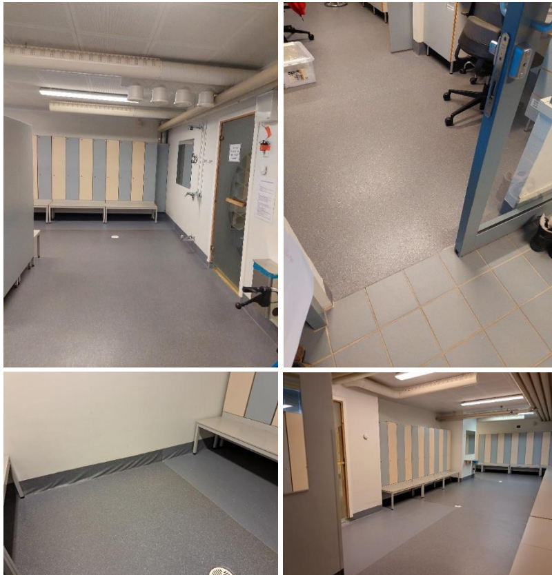
Kuvat 17a...d. Pukuhuoneissa (kuva a) ja valvomossa (kuva b) on lattiapäällysteenä muovimatto ylösnostoilla. Miesten pukuhuoneen lattia-seinäliittymissä muovimatto on rypyillä (kuva c). Pukuhuoneiden lattiapäällysteitä on ilmeisesti paikoin uusittu (kuvat c ja d).
