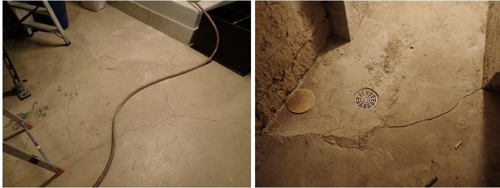
Kuvat 10a ja b. Laajennusosan alapohjan betonilaatta on halkeillut kauttaaltaan teknisen tilan osalla sekä lattiapinnoite on kulunut. Alkuperäisen osan huoltokäytävällä alapohjan betonilaatassa on joitakin halkeamia, pinnoite puutteellinen.
