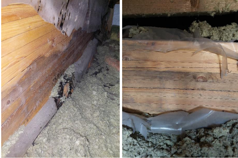
Kuvat 65a ja b. Yläpohjan liimapuupalkeissa todettiin kosteuden aiheuttamia jälkiä laajoilla alueilla. Puukolla arvioitaessa rakenteissa ei havaittu lahoa tai viitteitä pehmenemisestä. Paikoin liimapuupalkeissa todettiin vaakasuuntaisia halkeamia.
