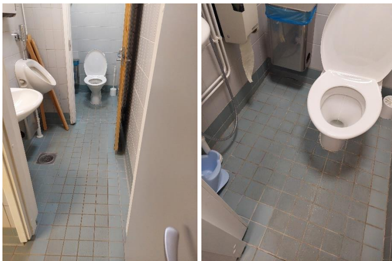
Kuvat 80a ja b. Yleiskuvat pesutilojen yhteydessä olevasta wc-tilasta. Keraamisissa laatoissa ja saumauksissa todettiin paikoin melko voimakasta likaantumista.
