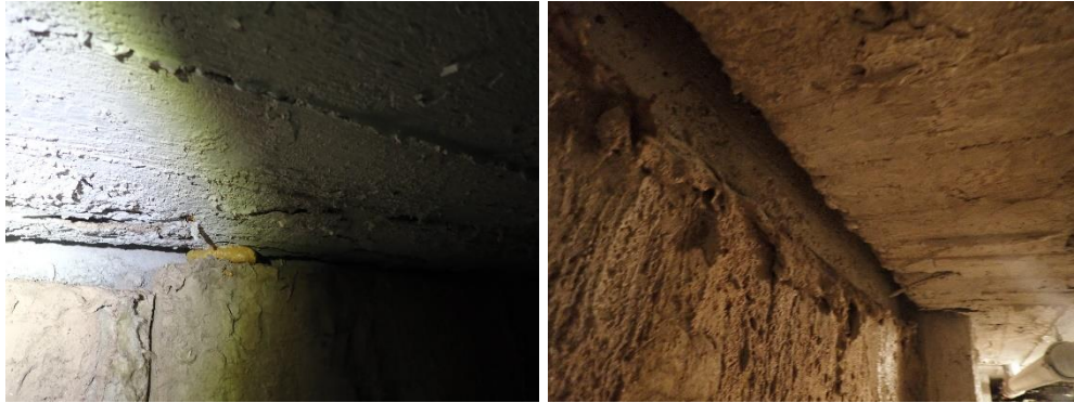
Kuvat 12a ja b. Vanhan osan huoltokäytävällä välipohjan ja maanvastaisen seinän välissä on rako (tuloilman kulkeutuminen ensimmäiseen kerrokseen).
