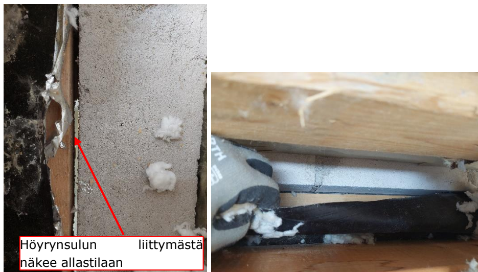
Kuvat 68a ja b. Laajennusosan yläpohjatilasta tehdyn rakenneavauksen kohdalla höyrynsulun tiiveydessä todettiin merkittäviä puutteita.
