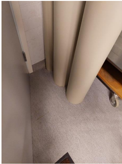
Kuva 32. Yleiskuva epätiiviestä lattian läpiviennistä.
