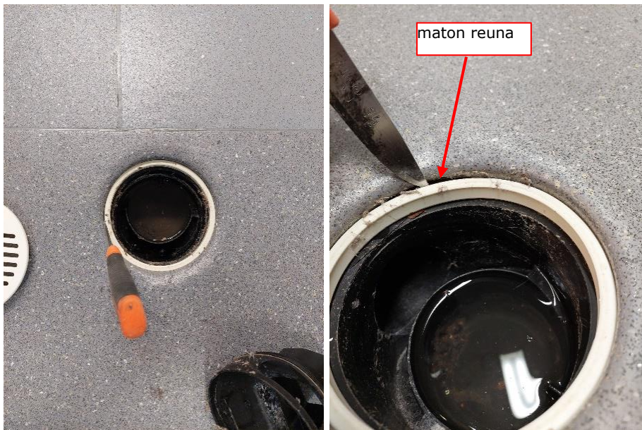
Kuvat 19a ja b. Lattiakaivojen toteutuksessa todettiin lähes poikkeuksetta puutteita. Lattiapäällystettä ei ole näkyvissä kiristysrenkaan alapuolella, vaan päällyste loppuu kiristysrenkaan taakse.
