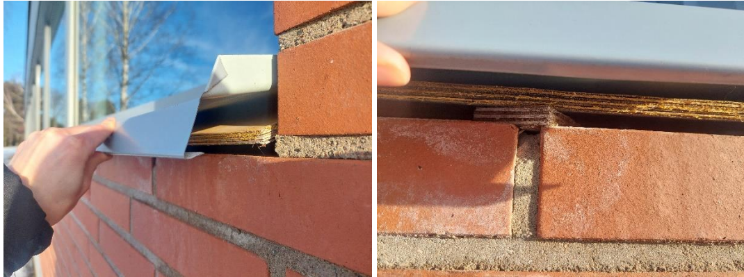
Kuvat 41a ja b. Vesipeltien toteutuksessa ei havaittu merkittäviä puutteita, mutta yksittäisen ikkunapellin kiinnitys on puutteellinen. Ikkunapelti on asennettu vanerilevyn päälle, jonka alapuolella on korokepalat ulkoseinän tuulettuvuuden varmistamiseksi.
