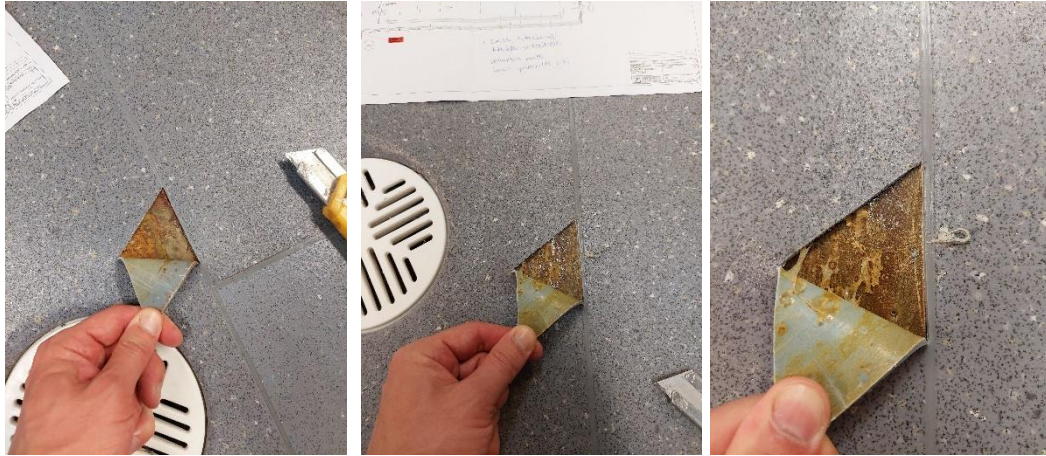
Kuvat 25a...c. Yleiskuvat viiltomittauksista 1 ja 2. Kuvissa on havaittavissa selviä värimuutoksia muovimattopäällysteen kiinnitysliimassa.
