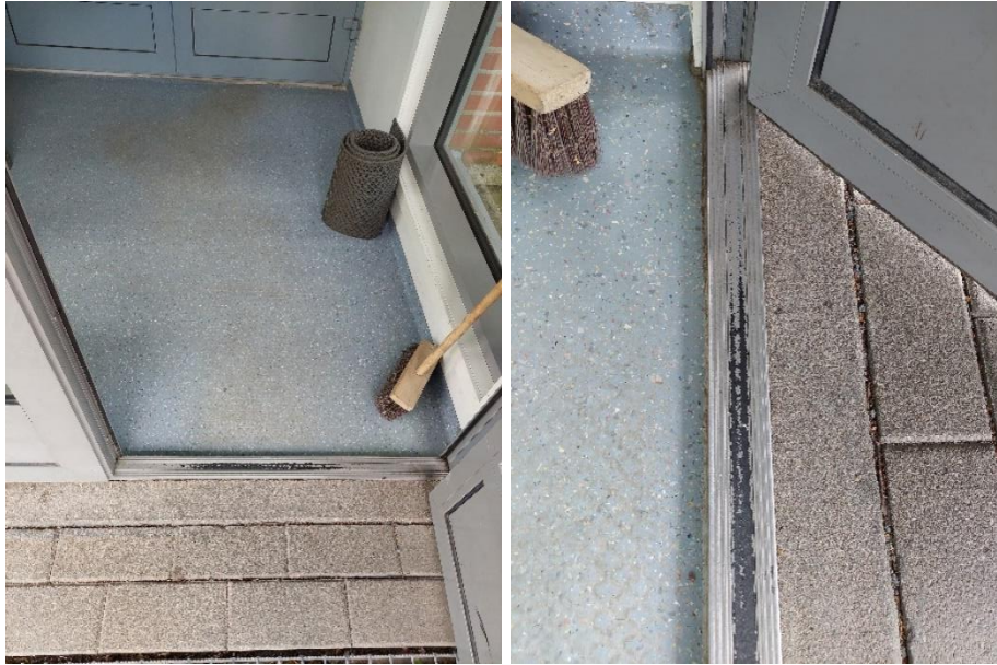
Kuva 20. Tuulikaapin ulko-oven kohdalla todettiin vertailuarvoa korkeampia pintakosteustunnistimen lukemia. Kynnyksen kohdalla muovimatossa ei ole ylönostoa, vaan muovimatto on tiivistetty kynnykseen elastisella massalla.
