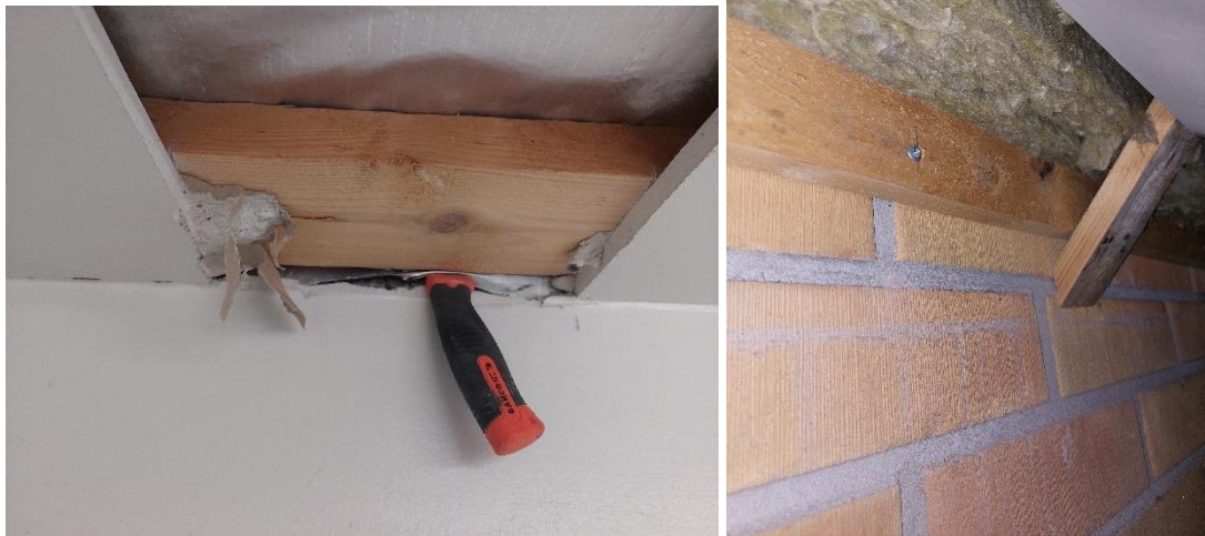
Kuvat 77a ja b. Esimerkkikuvat yläpohjan höyrysulkumuovin ilmatiiveyspuutteista. Kuva a=aula, kuva b=allastila.
