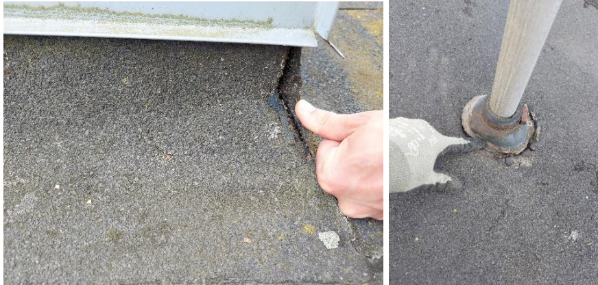
Kuvat 61a ja b. Vesikatteen läpivientien kohdilla todettiin vesitiiveyspuutteita.
