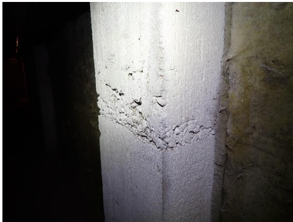
Kuva 13. Alkuperäisellä osalla huoltokäytävällä olevien pilareiden betoni on paikoin harvaa.
