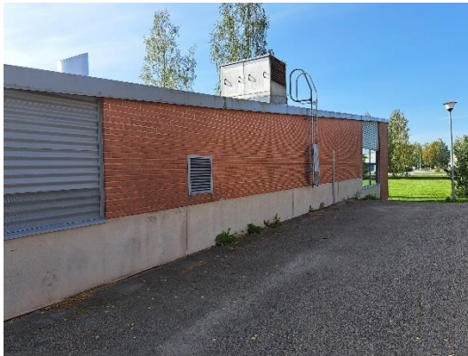
Kuvat 43a...c. Alkuperäisen rakennuksen osan sokkelissa on havaittavissa maalipinnoitteen hilseilyä ja rapautumaa (kuvat a ja b). Laajennusosan sokkelia ei ole pinnoitettu eikä sokkelissa havaittu silmämääräisesti merkittävää vaurioitumista (kuva c).
