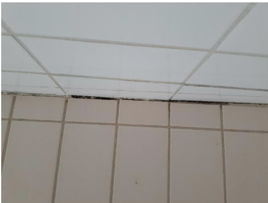
Kuva 18. 25 metrin altaan pohjan ja seinän liittymä. Nurkka-alueen elastiset saumaukset ovat osittain irronneet.
