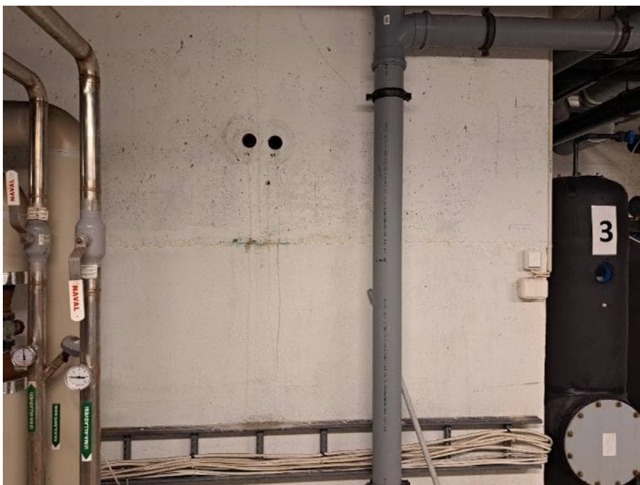
Kuva 82. Ison tasausaltan seinämä. Altaan pohjan ja perustuksen rajapinnassa on havaittavissa vanhoja vuotojälkiä ja härmettä.
