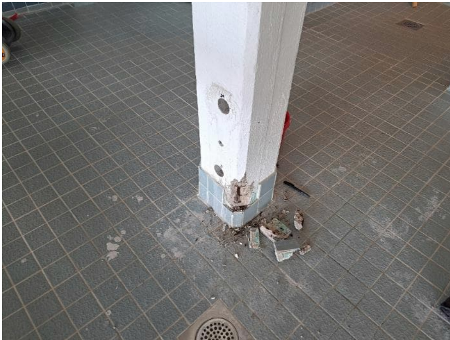
Kuva 66. Pilari, tasopinnan keskialue, näytteenotto kohta N30 ja N31. Pilarissa havaittiin alustastaan irti olevia pintarakenteita sekä betonia. Alustastaan irti olleet materiaalit poistettiin käsityökaluja käyttäen.
