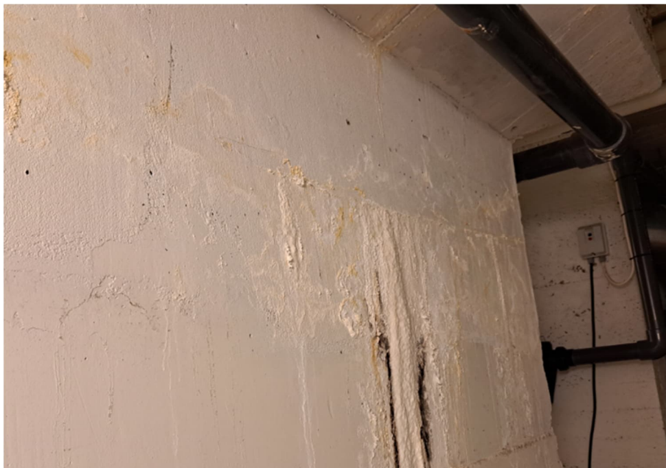
Kuva 85. Pienen taseusaltan seinä. Lastenaltaan ja taseusaltan seinämän liittymässä on vuotojälkiä, kiteytymiä sekä raudoitteiden korroosiotuotteita.
