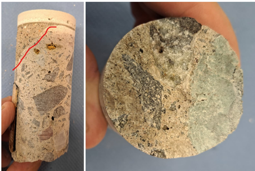
Kuva 29. Näyte N4 altaan seinästä. Laatoituksen tartunta alustaan on puutteellinen ja laastikamman jäljet ovat selkeästi nähtävissä. Laatan ja laastin rajapinnassa on myös kiteytymiä. Näytteen murtopinta leikkaa kiviainesten läpi.
