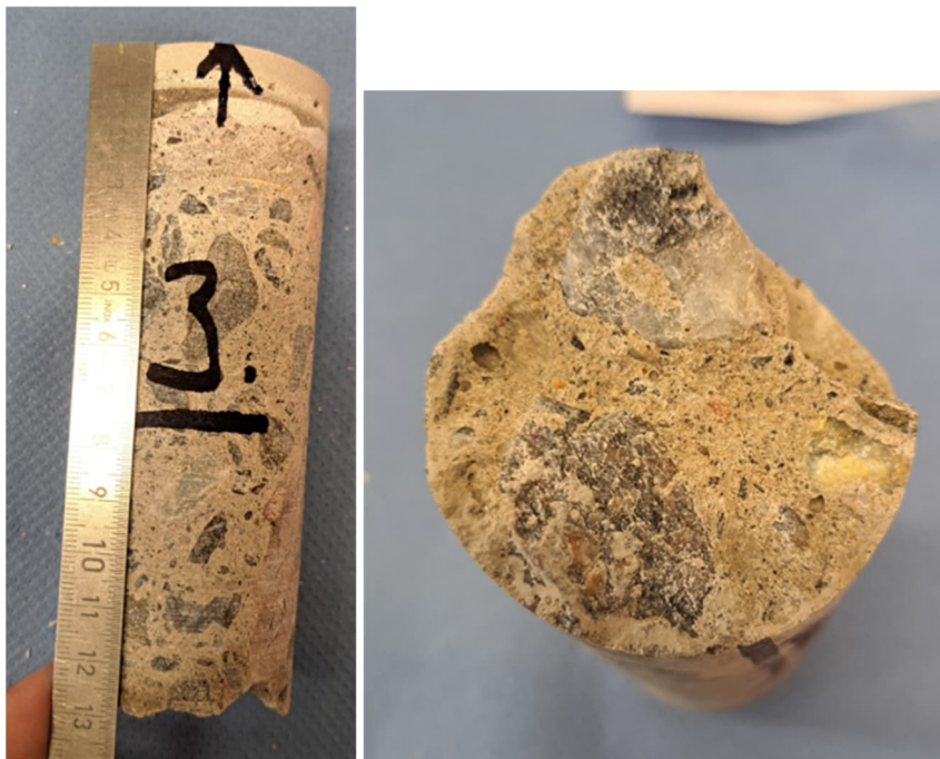
Kuvat 28 a ja b. Näyte N3 altaan seinästä. Näytteen ulkopinnassa on keraaminen laatta ja kiinnityslaasti. Kiinnityslaastin alla on useita eri tasoitekerroksia. Näytteen murtopinnalla on haljenneita kiviä.
