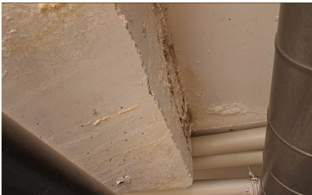
Kuva 49. Lastenaltaan konsoli. Konsolin ulkopinnassa on havaittavissa vuotojälkiä ja kiteytymiä sekä pintamateriaalin ja betonin vaurioitumista.
