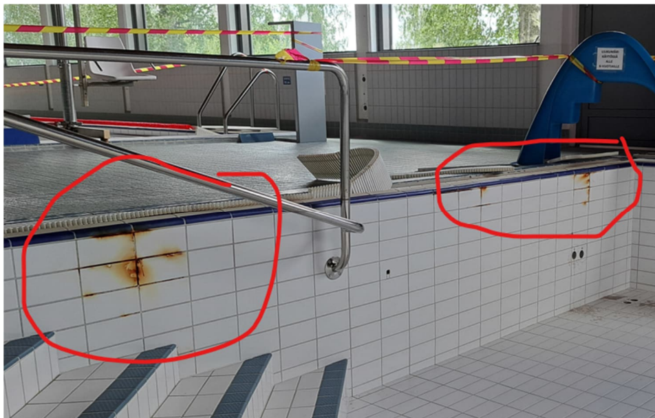
Kuva 46. Lastenaltaan seinäpinta. Seinäpinnan ruostejälkiä.
