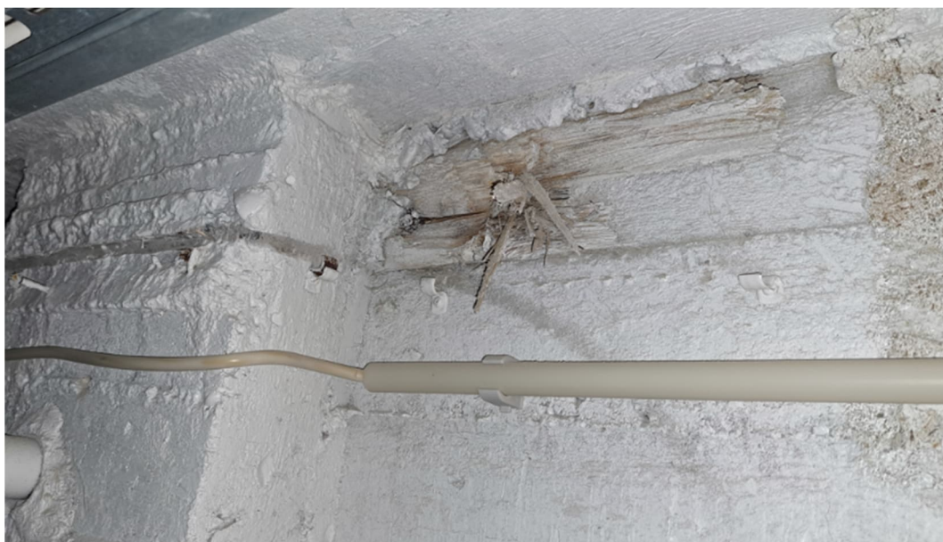
Kuva 22. 25 metrin allas, altaan ulkopinta. Altaan ulkopinnalla on vanhoja muottilautoja.
