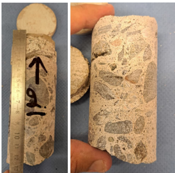
Kuvat 27 a ja b. Näyte N2 altaan seinästä. Näytteen ulkopinnassa on pintarakenteet ja tasoitekerros. Keraaminen laatta sekä tasoitekerros irtosivat porauksen yhteydessä. Runkobetonin kiviaineksessa on lievää halkeilua.
