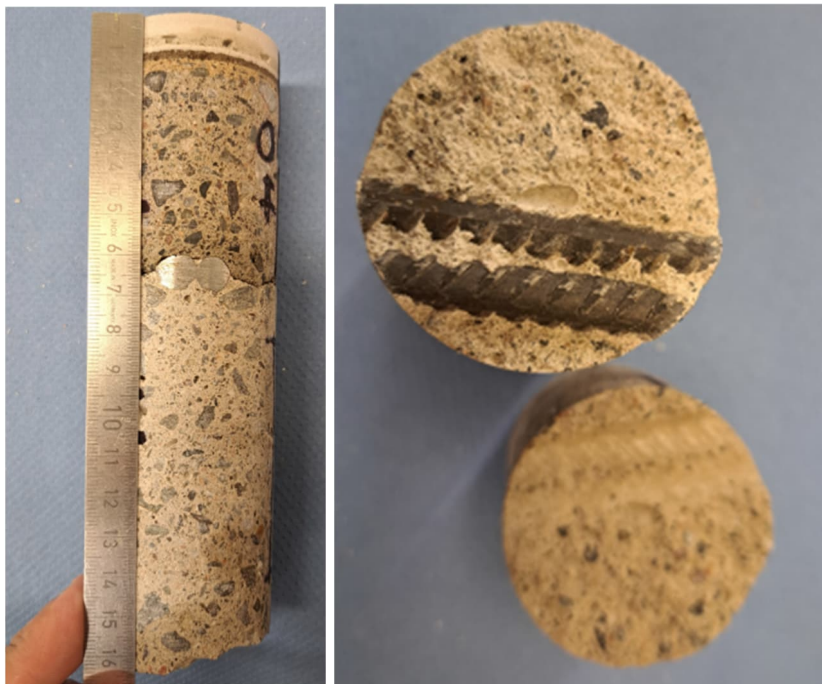
Kuvat 32 a ja b. Näyte N7 altaan seinästä. Näyte N7 hajosi poratessa. Näytteessä on raudoitteet noin 40 mm:n syvyydellä rakenteen ulkopinnasta. Raudoitteet ovat silmämääräisesti arvioituna hyväkuntoiset. Näytteen kiviaines on silmämääräisesti arvioituna huomattavasti pienempää muihin näytteisiin nähden.
