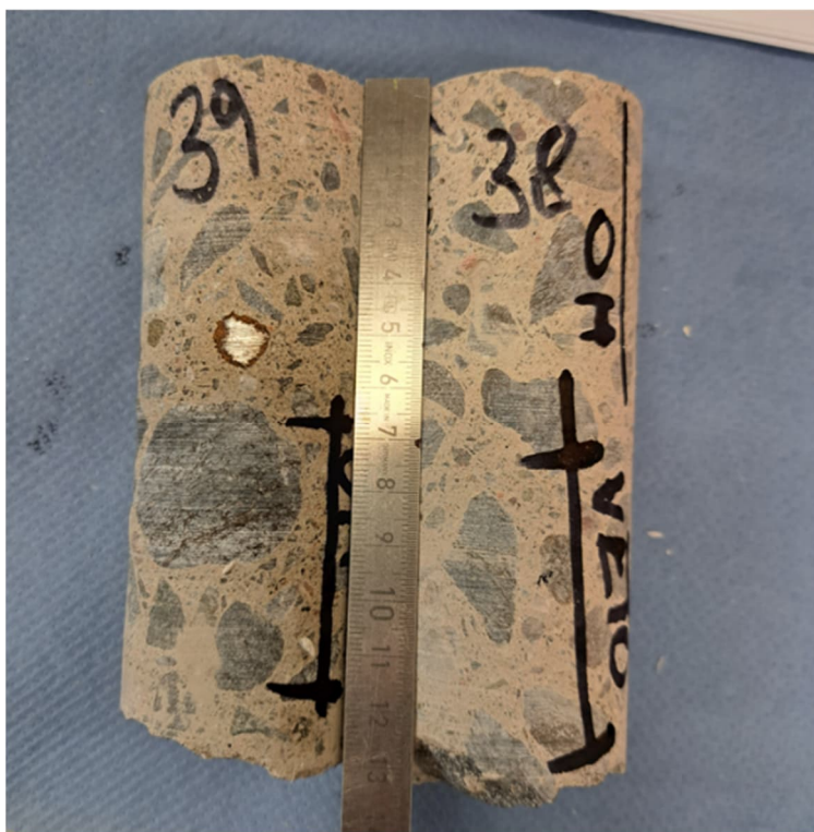
Kuva 37. Näytteet N38 ja N39 altaan ulkopinnasta. Näytteessä N39 on raudoite noin 45 mm:n syvyydellä rakenteen ulkopinnasta. Raudoite on silmämääräisesti arvioituna hyväkuntoinen.
