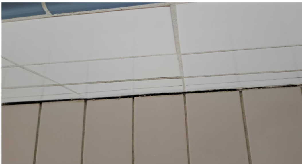
Kuva 19. 25 metrin altaan pohjan ja seinän liittymä lepotoson kohdalla. Nurkka-alueen elastiset saumat ovat osittain irronneet.
