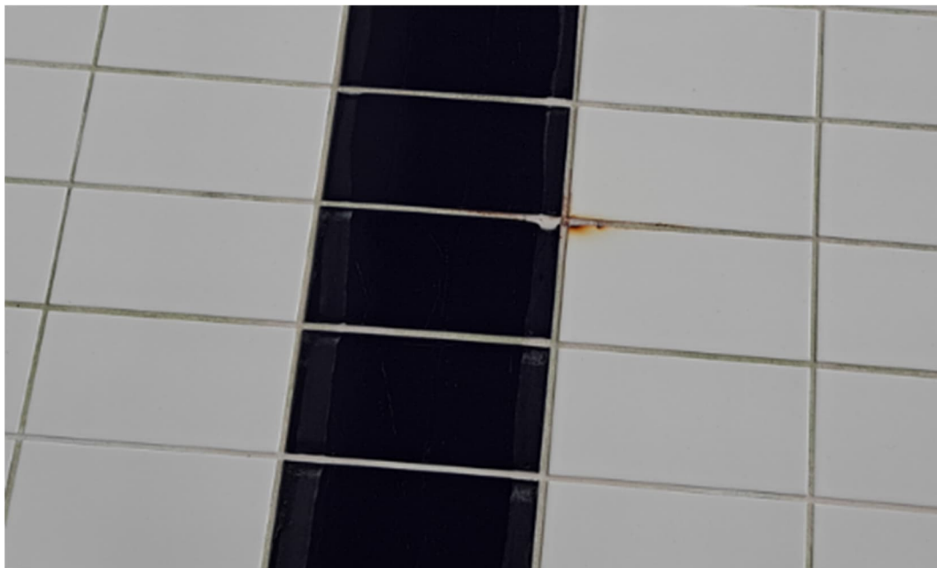
Kuva 21. 25 metrin allas. Altaan pohjassa on yksittäisiä ruostejälkiä.
