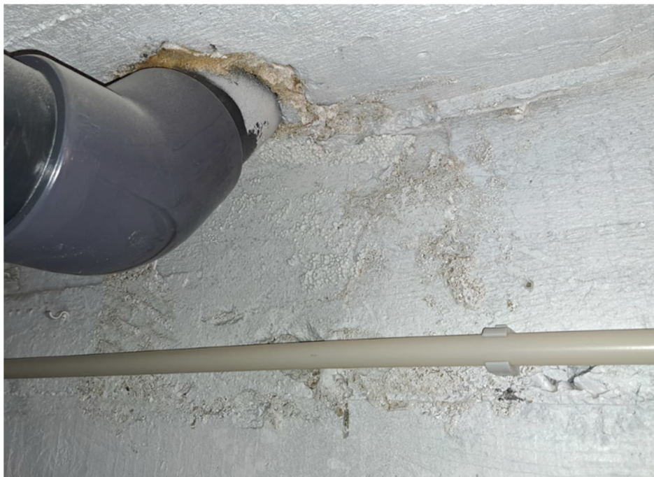
Kuva 23. 25 metrin allas, altaan ulkopinta. Altaan ulkopinnalla on liittymien alueella vuotojälkiä sekä kalkkihärmettä.
