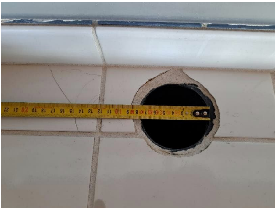
Kuva 15. 25 metrin altaan loiskekouru. Loiskekourun vedenpoiston liittymä on epäsiisti. Loiskekourun laatassa halkeama. Puutteet loiskekourussa ja liittymässä voivat johtaa liittymän epätiiveyteen.
