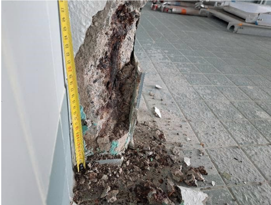
Kuva 65. Allashuoneen pilari, väliseinän alue, näytteenotto kohta N28 ja N29. Pilarissa havaittiin alustastaan irti olevia pintarakenteita sekä betonia. Alustastaan irti olleet materiaalit poistettiin käsityökaluja käyttäen. Pilarin alaosassa raudoitteiden korroosio on edennyt kohtalaisen pitkälle.
