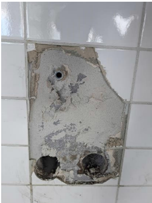
Kuva 17. 25 metrin altaan seinä, näytepiste 1. Alustastaan irti olevat laatoitukset poistettiin porauskohdan vierustoilla.
