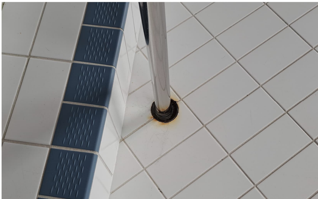
Kuva 47. Lastenaltaan portaiden keskikaiteen kiinnityskohdassa on ruostejälkiä.
