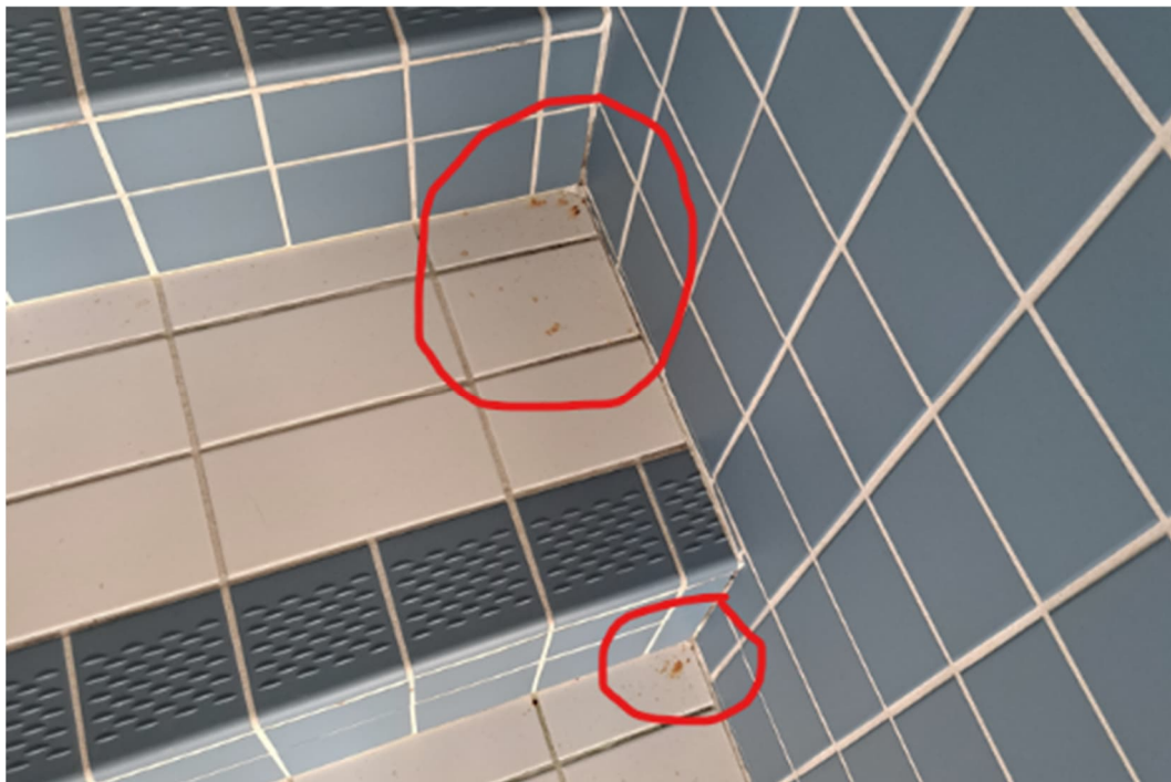
Kuva 13. 25 metrin altaan portaiden nurkka-alueilla laatoituksessa on ruostejätkiä. Ruostejätket johtuvat todennäköisesti altaaseen pudonneista irtoesineistä.
