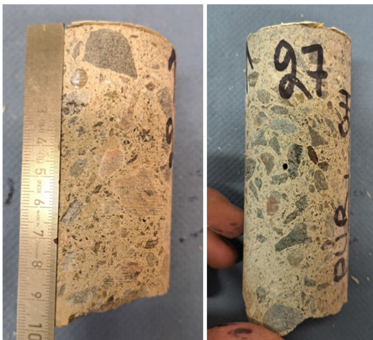
Kuvat 74 a ja b. Näytteet N26-N27 allashuoneen pilareista. Näytteessä N26 raudote sijaitsee noin 15 mm:n syvyydellä rakenteen ulkopinnasta. Näytteiden betonissa tai betonin raudoitteessa ei havaittu silmämääräisesti viitteitä vaurioitumisesta.
