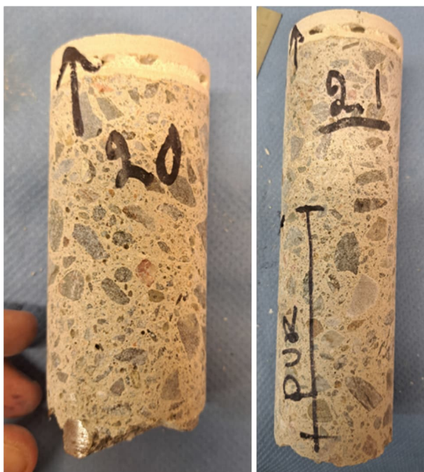
Kuvat 56 a ja b. Näytteet N20 ja N21 lastenaltaan pohjasta. Näyte N20 katkesi raudoitteen kohdalta. Raudoite on silmämääräisesti arvioituna hyväkuntoinen. Laattojen kiinnityslaastin peittoaste on puutteellinen.
