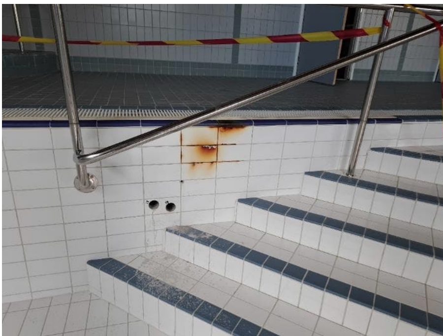
Kuva 45. Lastenaltaan seinäpinta. Seinäpinnalla on ruostejälkiä.
