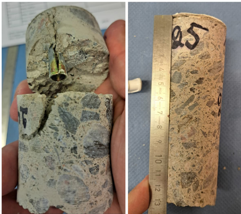
Kuvat 73 a ja b. Näytteet N24-N25 allashuoneen pilareista. Näytteessä N24 oli vanha ankkuri ja näyte hajosi poratessa. Näytteiden betonissa ei havaittu silmämääräisesti viitteitä vaurioitumisesta.
