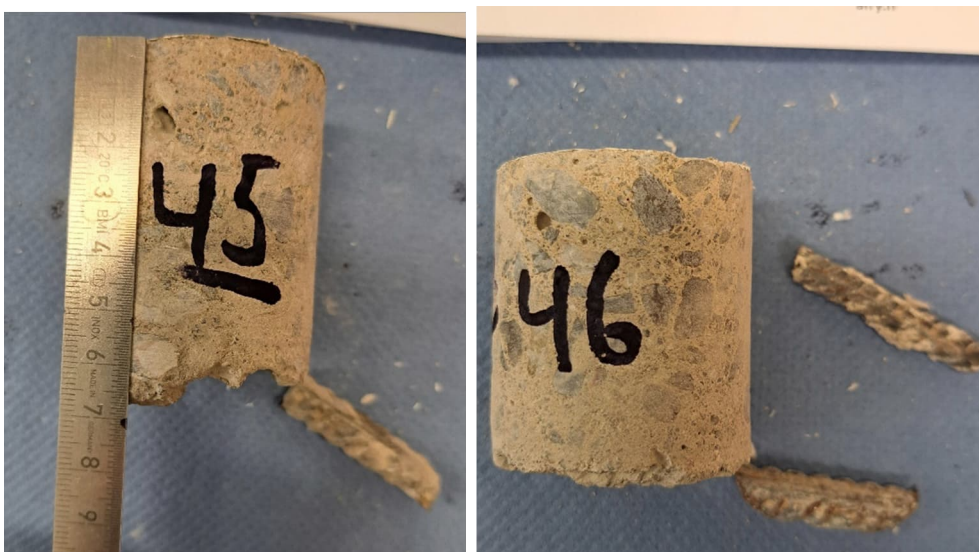
Kuvat 96 a ja b. Näytteet N45 ja N46 maanvastaisesta seinästä. Näytteissä raudoitteet sijaitsevat noin 60 mm:n syvyydellä rakenteen ulkopinnasta, murtopinnalla. Näytteiden betonissa tai betonin raudoitteessa ei havaittu silmämääräisesti viitteitä vaurioitumisesta.
