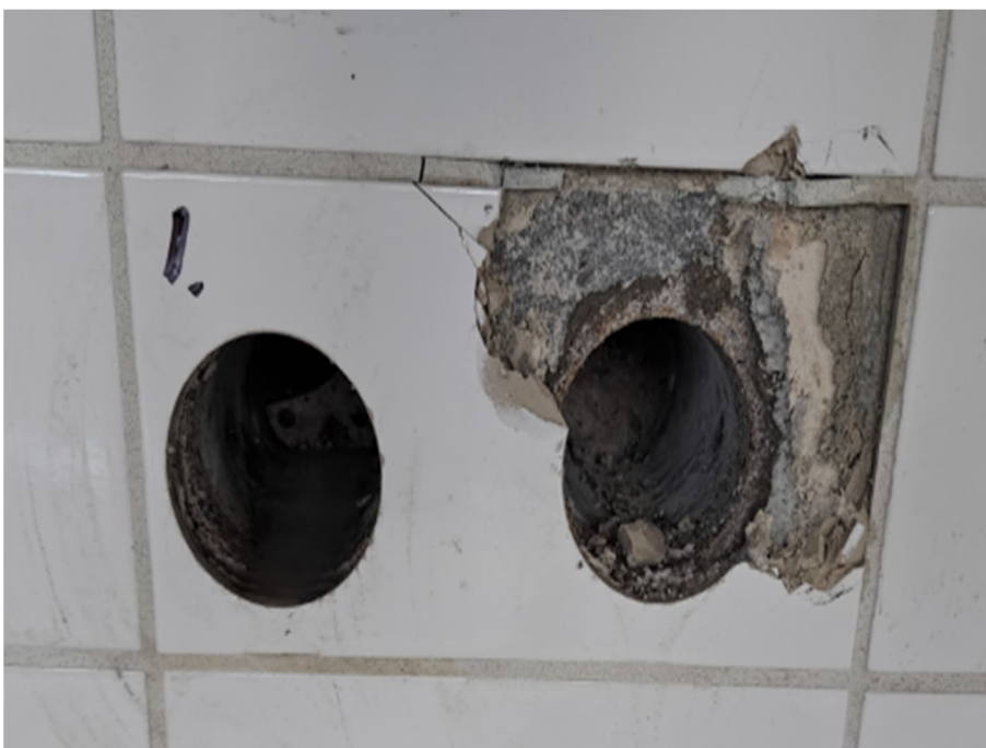
Kuva 16. 25 metrin altaan seinä, näytepiste 1. Laatoitus oli porauskohdan alueella irti alustastaan (ns. kopoa) ja laatoitus irtosi porauksen yhteydessä. Irronneen alueen kohdalla laatan taustalla oli havaittavissa useita eri pintakerrosmateriaaleja. Osa pintamateriaaleista ei ollut kovettunut.
