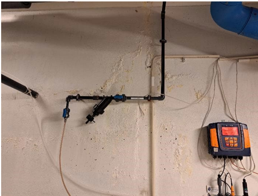
Kuva 83. Ison tasausaltan seinämä. Altaan ulkoseinässä on havaittavissa vanhoja vuotojälkiä ja härmettä.
