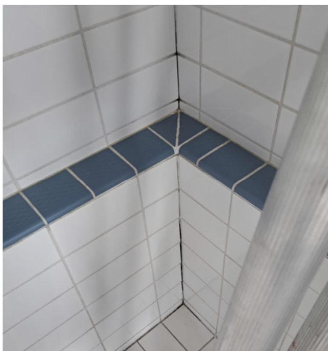
Kuva 20. 25 metrin altaan seinän sekä pohjan liittymät. Nurkka-alueiden elastiset saumat ovat osittain irronneet.
