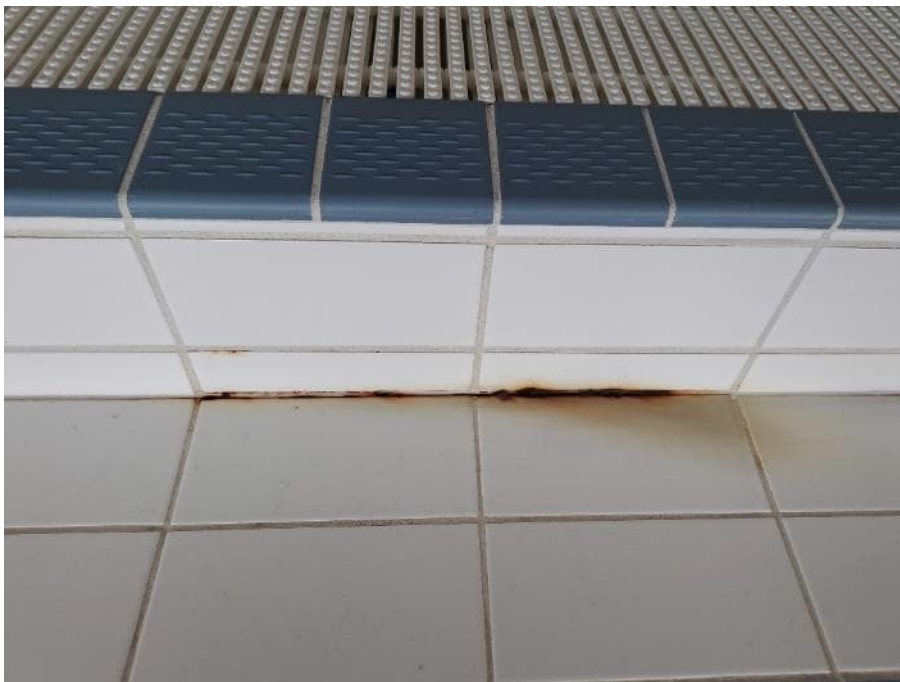
Kuva 44. Lastenaltaan portaat. Portaiden nurkka-alueella on ruostejälkiä.
