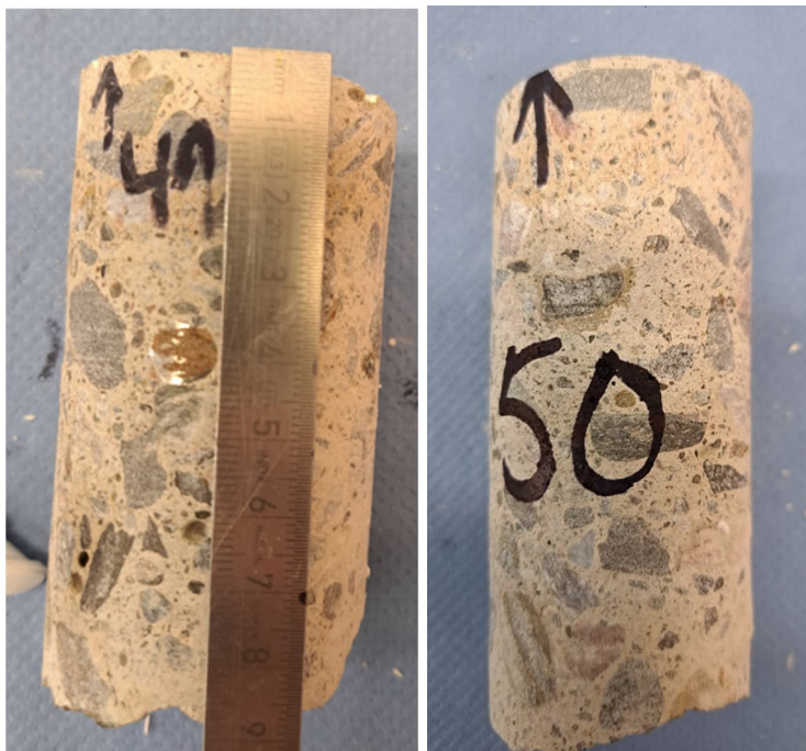
Kuvat 91 a - b. Näytteet N49-N50 tasausaltaan ulkopinnasta. Näytteiden ulkopinnassa on pinnoite. Näytteessä N49 raudoite sijaitsee noin 35 mm:n syvyydellä rakenteen ulkopinnasta. Näytteiden betonissa tai betonin raudoitteessa ei havaittu silmämääräisesti viitteitä vaurioitumisesta.
