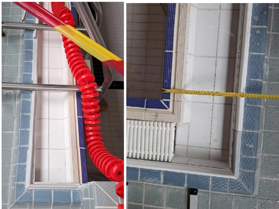
Kuva 7. Ison altaan loiskekouru. Loiskekourun ulkoreunaan on asennettu muovitiiviste, jolla todennäköisesti on pyritty estämään veden pääsy tasopinnalle. Loiskekourun ja tasopinnan liittymässä on elastinen sauma.
