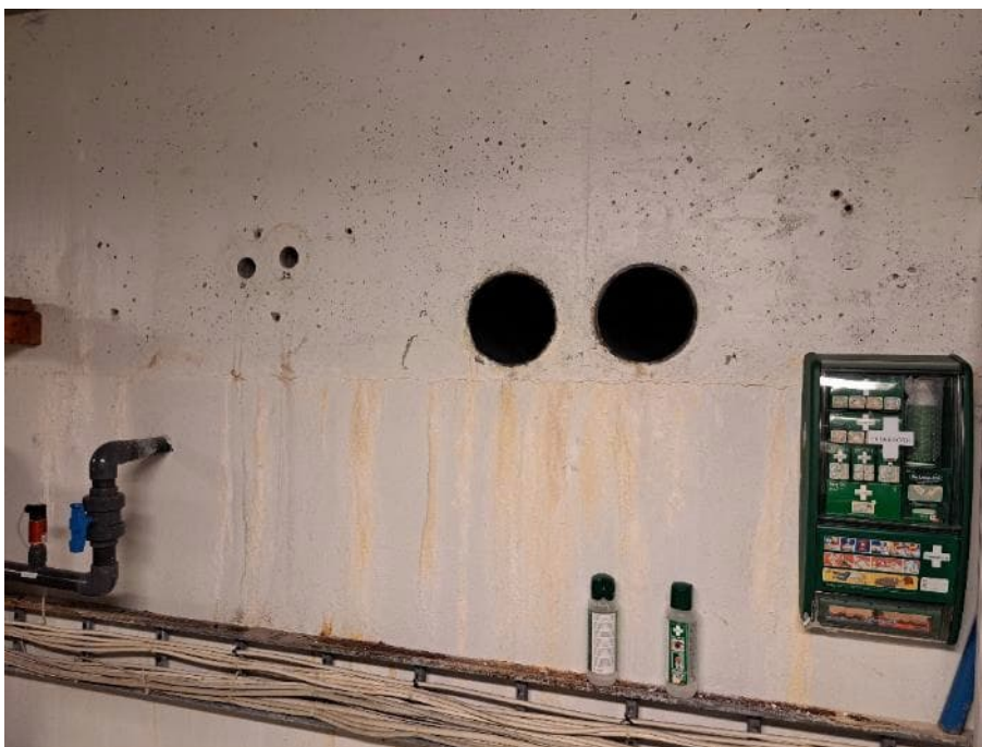
Kuva 84. Ison tasausaltan seinä. Altaan ulkoseinässä on havaittavissa vanhoja vuotojälkiä ja härmettä.
