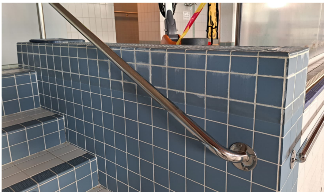
Kuva 14. 25 metrin altaan seinälaatoitus portaiden kohdalla. Vedenpinnan yläpuolisessa laatoituksessa on havaittavissa kalkkihärmettä, joka johtuu rakenteen kastumis-kuivumissyklistä. Altaan vedenpinnan raja on selkeästi havaittavissa.
