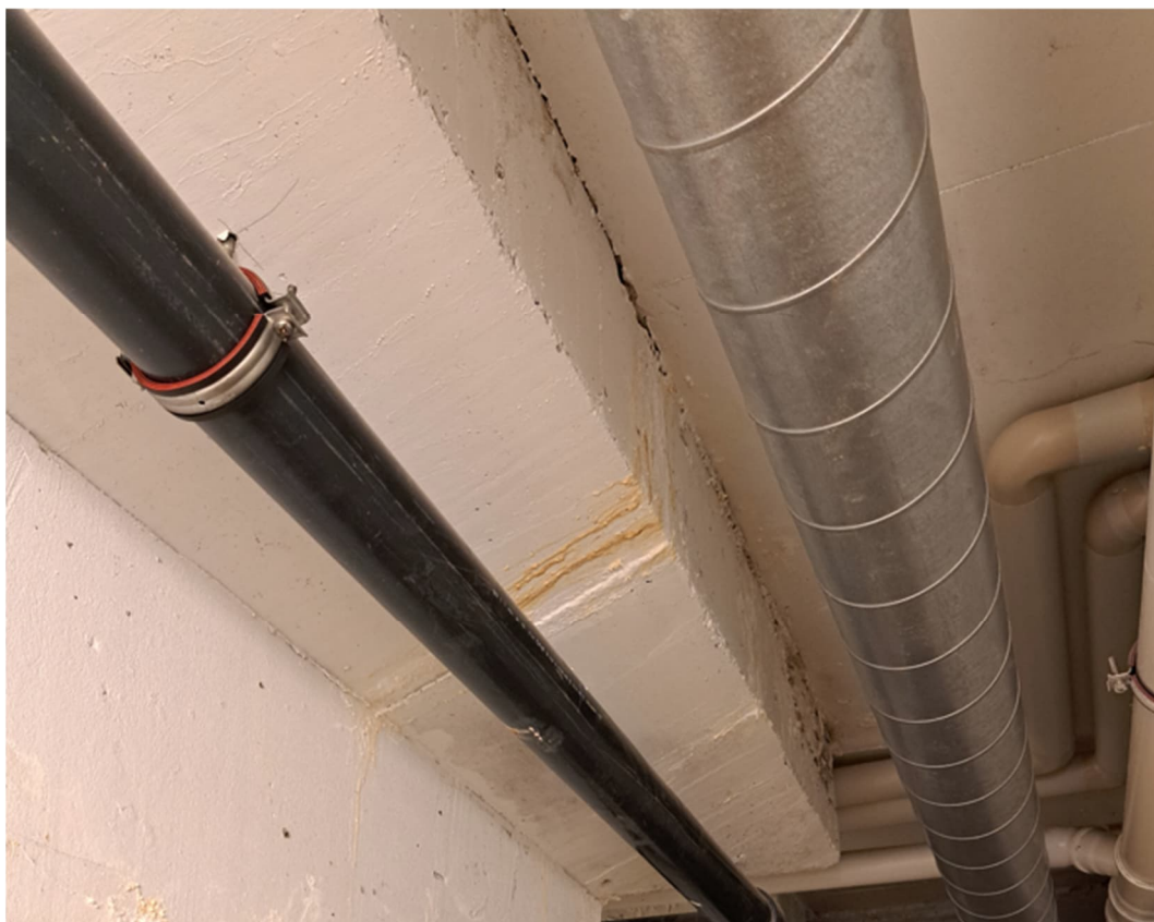
Kuva 48. Lastenaltaan konsoli. Konsolin ulkopinnassa on havaittavissa vuotojälkiä sekä kiteytymiä.
