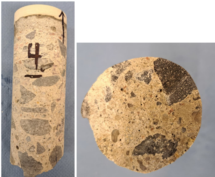
Kuvat 30 a ja b. Näyte N4 altaan seinästä. Näytteen ulkopinnassa on pintarakenteet, joiden alla on n. 10 mm:n tasoitekerros/pintavalu. Näytteen N4 kiinnityslaastin tartunta on puutteellinen; laatan ja kiinnityslaastin rajapinnassa on havaittavissa laastikamman jäljet. Näytteen murtopinta leikkaa kiviainesten läpi.
