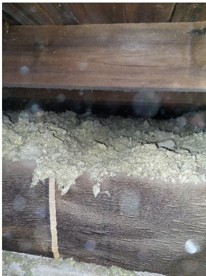
Kuva 7. Näyte ASB8 + PAH (yläpohjan tervapaperi) ei sisällä asbestia, eikä sen PAH-yhdistepitoisuudet ylitä vaarallisen jätteen raja-arvoja.
