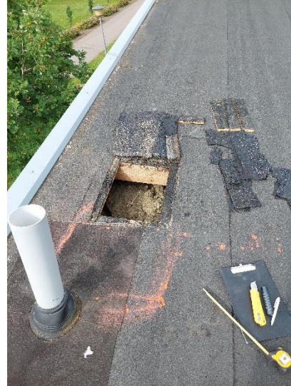
Kuva 10. Näyte ASB11 + PAH (vesikate) ei sisällä asbestia, eikä sen PAH-yhdistepitoisuudet ylitä vaarallisen jätteen raja-arvoja.
