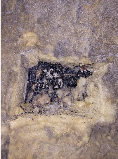
Kuva 13. Näyte ASB14 + PAH (Kellarin seinän bitumisively) ei sisällä asbestia, eikä sen PAH-yhdistepitoisuudet ylitä vaarallisen jätteen raja-arvoja
