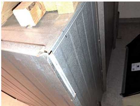
Kuva 19. TK1 tuloilmakoneen konerungossa (äänenvaimentimen jälkeinen moduuli) havaittiin lievää ilmavuotoa.
