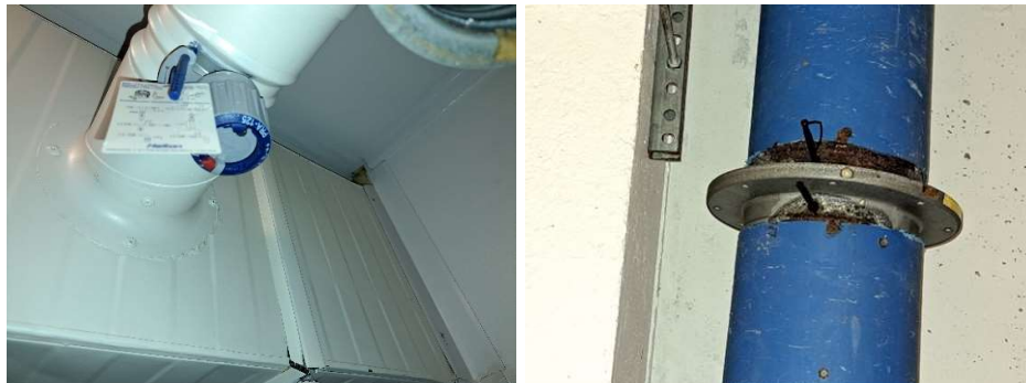
Kuva 26. Varastotilan haarakanavassa havaittu kertasäätöpelti, sekä kellaritilassa silmämääräisesti huonokuntoinen / jumittunut säätöpelti.
