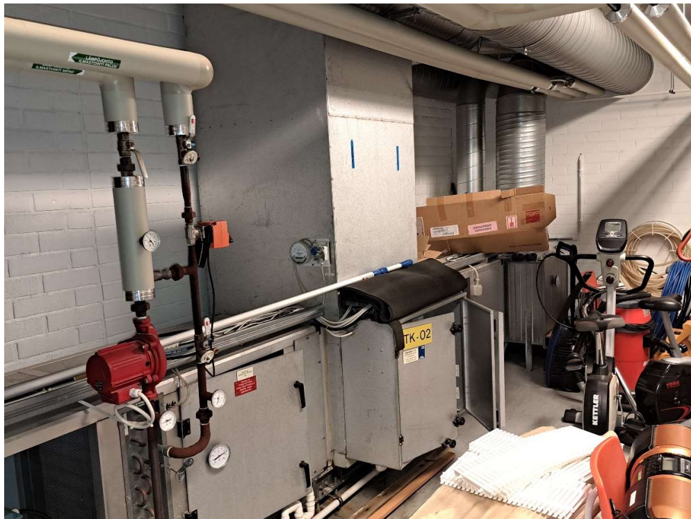
Kuva 7. Yleiskuva ilmanvaihtokoneesta TK2
