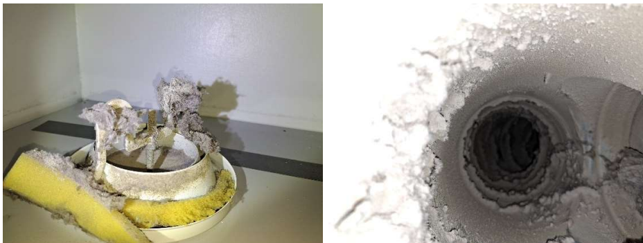
Kuva 25. Poistoilmakanavat- ja päätelaitteet olivat yleisesti hyvin likaisia, kuvat naisten pukuhuoneen poistoilmaventtiilistä sekä poistoilmakanavasta.
