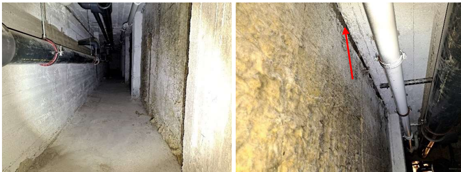
Kuva 20. Allastilan painekammiossa on pinnoittamatonta mineraalivillaa tuloilman virtausreitillä (nuoli)
