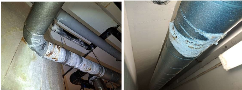
Kuva 23. Kellaritilassa kulkevissa ilmanvaihtokanavissa on paikallisia korroosiovaurioita.
