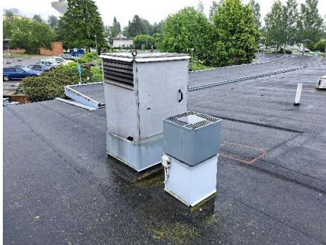
Kuva 18. TK2 raitis- ja jäteilmalaite (LTO) sijaitsee wc-tilojen erillispoistopuhaltimen välittömässä läheisyydessä, jolloin määräysten mukaista suojaetäisyyttä ei saavuteta jäteilmalaitteen ja raitisilman sisäänottoaukon välillä.
