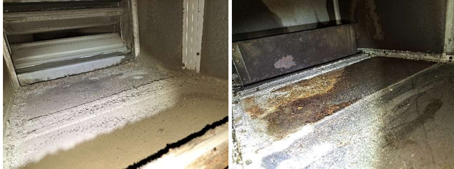
Kuva 13. Ilmanvaihtokoneen sisäpuoli on erittäin likainen ja osin korroosiohaitoitunut. Ulkoilmapelti ei sulkeutunut koneen sammussa.
