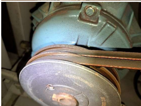
Kuva 6. Poistoilmapuhaltimen käyntiäänensä havaittiin mahdollisesti laakerivikaan viittaavaa poikkeavaa ääntä ja värinää. Puhaltimen siivekkeissä runsasta likakertymää. Hihnapyörä on erittäin kulunut.
