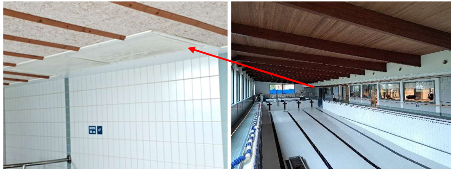
Kuva 22. Allastilan poistoilmasäleikkö on sijoitettu allastilassa matalan osan alakattoon, allastilassa ei ole muuta poistoilmavaihdon päätelaitetta.
