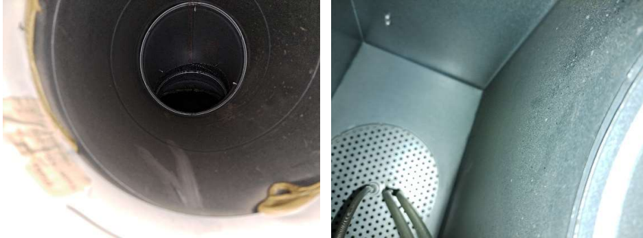
Kuva 24. Allastilan tuloilmakanavassa havaittiin paikoin runsasta likakertymää sekä valvomon tuloilmahajottajan tasauslaatikossa lievää likakertymää.
