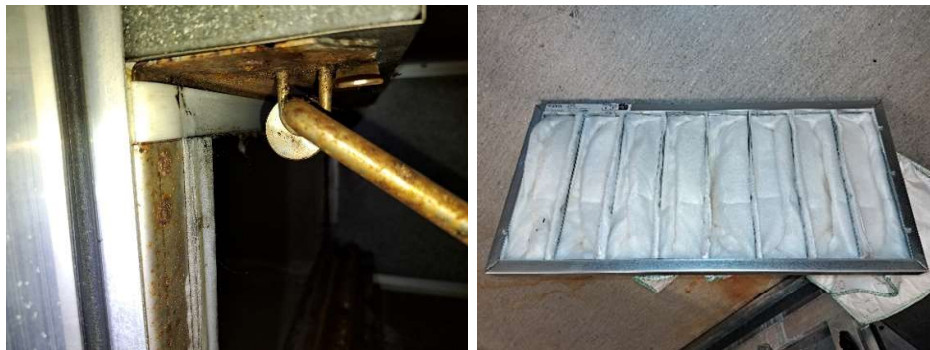
Kuva 14. Tuloilmasuodatin ei tiivistä kunnolla koneen runkoa vasten. Tuloilmasuodatin on puhdas.
