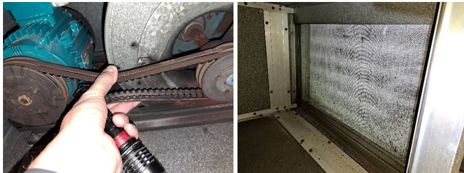
Kuva 15. Tuloilmapuhaltimen hihnan kireys on virheellinen. Lämmityspatterin painepuoli erittäin likainen ja lämmityspatterissa hapettumaa / korroosiohaittoja.
