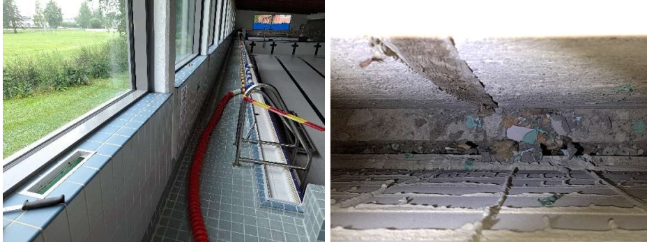
Kuva 21. Allastilan tuloilma puhalletaan osittain ikkunapenkkien kautta. Alkuperäisen allastilan tuloilma johdetaan ikkunapenkkeihin asennettujen tuloilmakanavien ja päätelaitteiden kautta. Rakennearineisessa tuloilmakanavassa / hormissa runsaasti epäpuhtautta sekä betonirakenteessa muottilautoja.
