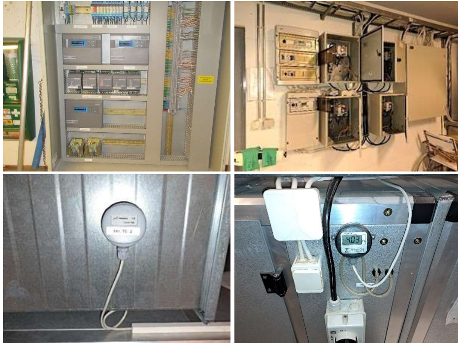
Kuva 27. Yleiskuvia rakennusautomaation valvonta-alakeskuksesta, ilmanvaihtolaitteiston taajuusmuuttajista sekä LTO-yksiköitä ohjaavista yksikkösäätimistä, anturoinneista sekä mittalaitteista.
