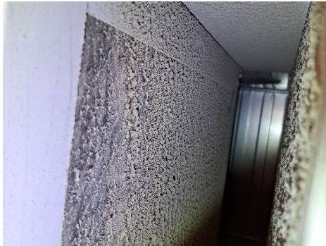
Kuva 11. Poistoilmapuolen äänenvaimennin on likainen.
