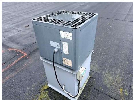
Kuva 17. Yleiskuva huippuimurista TK2PF1.2.
