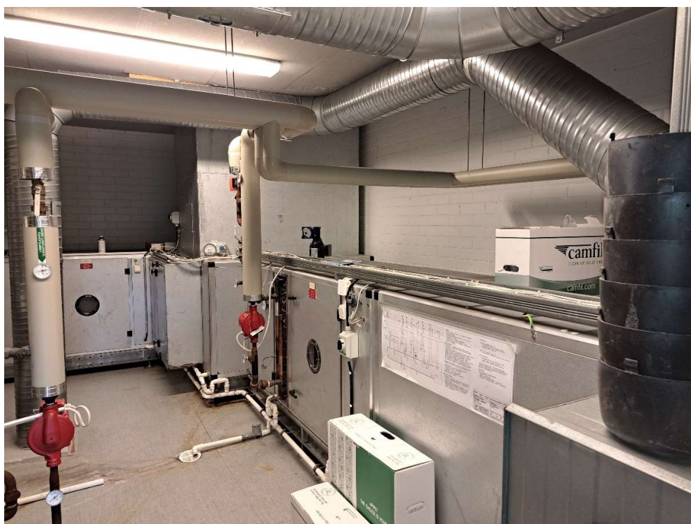
Kuva 1. Yleiskuva ilmanvaihtokoneesta TK1.
