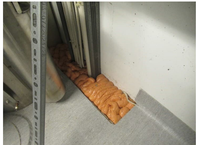
Tarkastettava läpivienti IV-konehuoneen lattiassa.
