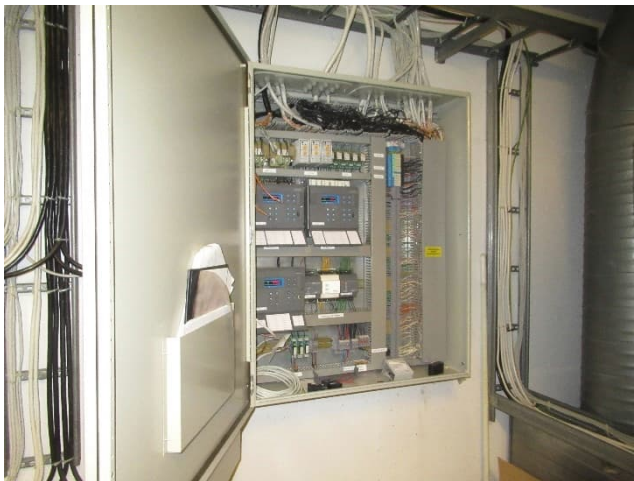
Alakeskus VAK IV-konehuoneessa.
