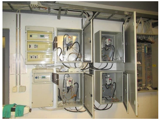
Taajuusmuuttajilta puuttuvat lisäpotentiaalintasaukset ja kotelosta tuuletusaukot.
