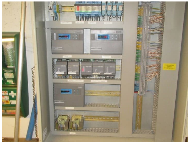
Alakeskus VAK vedenkäsittelytilassa.
