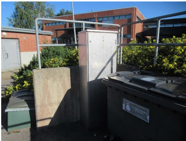
Liityntäpiste piha-alueella sähkökotelossa.
