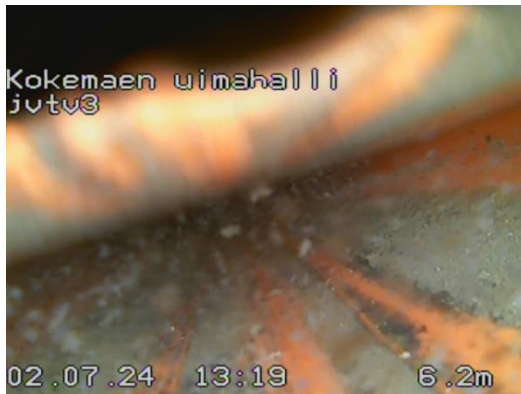
Kuva 3. Lievää painuman aiheuttamaa vesitäyttöä.
