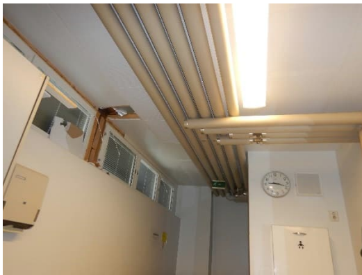
Kuva 5. Runkojohdot ja jakotuet näkyvillä pukuhuonetiloin katon kannakkeina.
