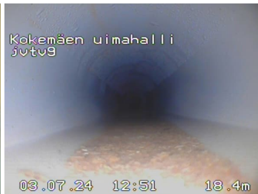
Kuva 10. Lievää painuman aiheuttamaa vesitäyttöä viemärissä.
