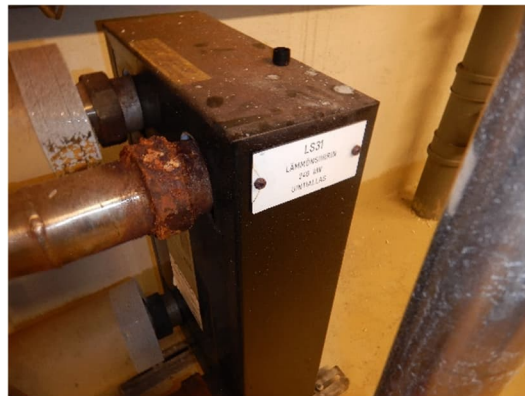
Kuva 4. Ulkopuolista korroosiota uima-al- taan lämmönsiirtimen liitoksessa.
