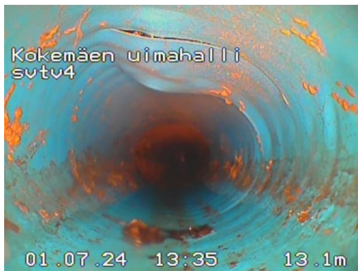
Kuva 15. Sisään painuma viemäri- n yläpinnassa.
