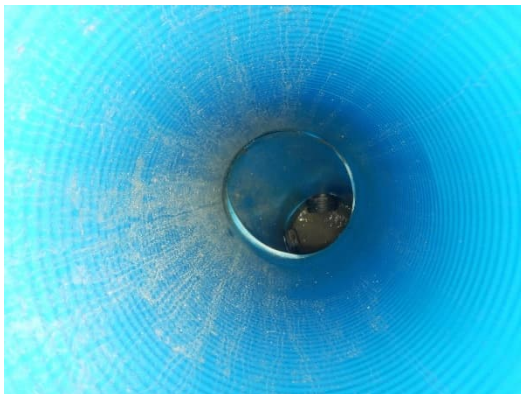
Kuva 47. Salaojakaivon runko on vääntynyt/vinossa, sok4.
