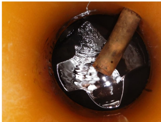
Kuva 27. Kaivon jvtk1 pohjakourussa seisoo vesi.
