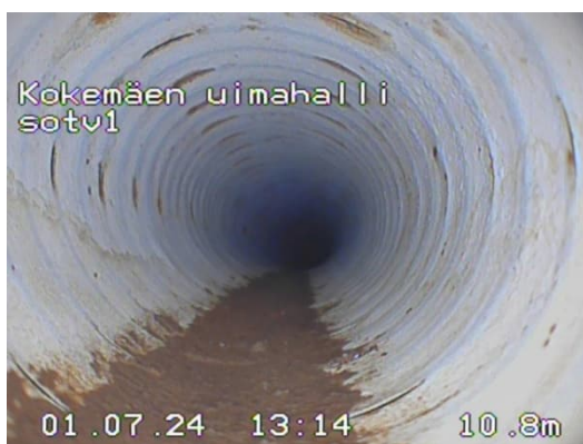
Kuva 26. Hieman lietettä salaojassa.
