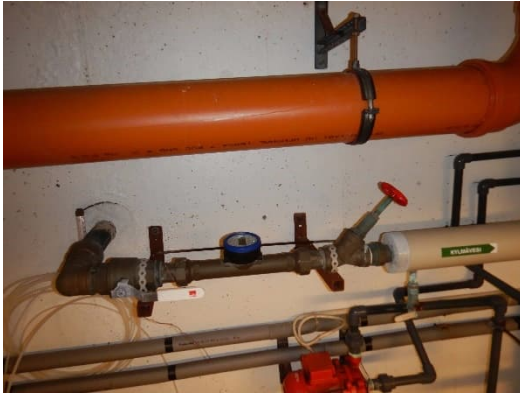
Kuva 15. Päävesimittari sulkuineen, tonttijohto on muovia.
