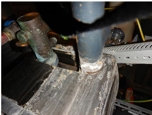
Kuva 3. Vanhoja vuotojälkiä lämmityk- sen siirtimessä.
