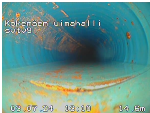
Kuva 23. Painuman aiheuttamaa vesitäyttöä viemärissä.
