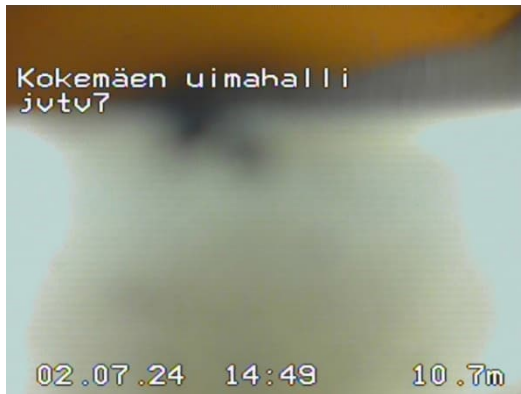
Kuva 7. Painuman aiheuttamaa vesitäyttöä viemärissä.
