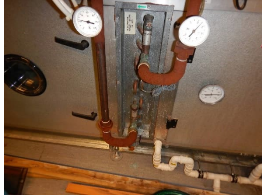
Kuva 14. Ulkopuolista korroosiota ilmanvaihdon lämmityksen teräsputkissa.
