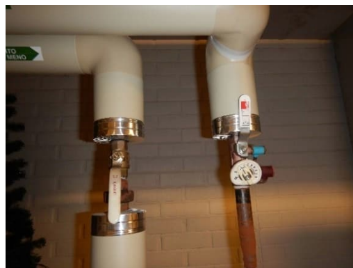
Kuva 8. Linjasulku- ja säätöventtiilipari, virtaamat on näyttötaulun mukaan säädetty.
