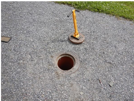
Kuva 26. Tarkastuskaivo jvtk1 sijaitsee hiekkatiellä.
