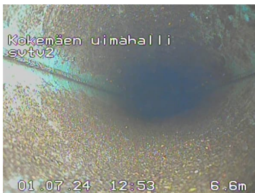
Kuva 11. Painuman aiheuttamaa vesitäyttöä viemärissä.
