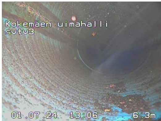
Kuva 13. Painuman aiheuttamaa vesitäyttöä viemäri-ssä.
