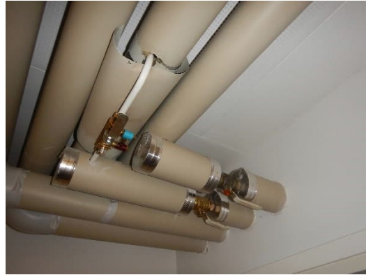
Kuva 20. Linjasulku- ja säätöventtiili-ryhmä.
