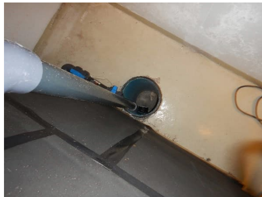
Kuva 48. Kellarin salaojakaivoon on johdettu uima-allaslaitteiston viemäriputki.
