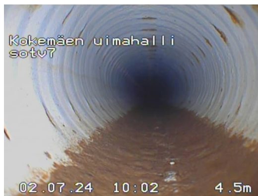
Kuva 31. Hieman lietettä salaojassa.
