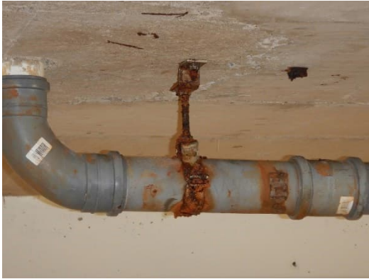
Kuva 33. Voimakasta korroosiota viemärin kannakkeessa.
