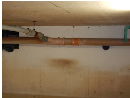
Kuva 36. Pohjarunkoviemäri haalistunut voimakkaasti tasausallastilassa.
