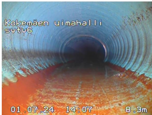
Kuva 19. Painuman aiheuttamaa vesitäyttöä viemärissä.
