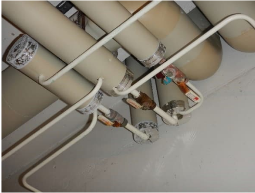
Kuva 19. Linjasulku- ja säätöventtiili-ryhmä.
