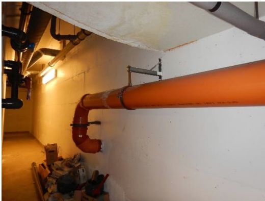
Kuva 35. Pohjarunkoviemäri kellaritilan seinällä.
