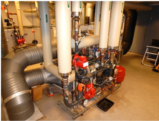
Kuva 1. Kaukolämmön alajakokeskus va- rusteineen.
