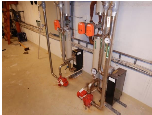
Kuva 2. Uima-altaiden lämmönsiirtimet varusteineen.
