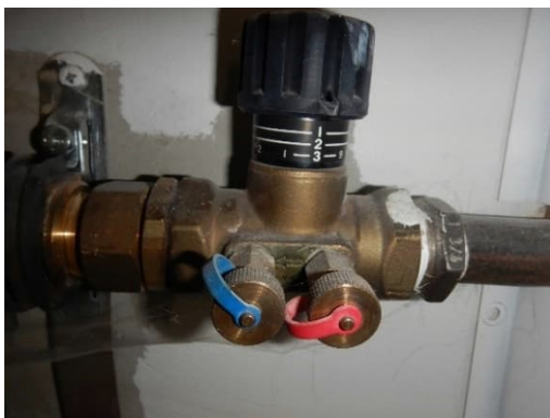
Kuva 7. Jakotukin säätö- ja sulkuventtiili. Säätö on täysin auki.
