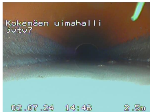
Kuva 6. Painuman aiheuttamaa vesitäyttöä viemärissä.
