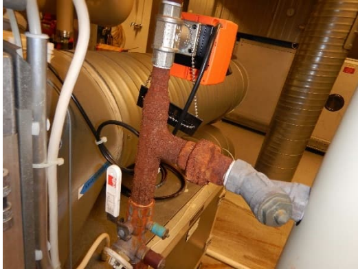
Kuva 13. Ulkopuolista korroosiota ilmanvaihdon lämmityksen teräsputkissa.
