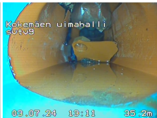
Kuva 24. Vieras esine viemärissä.
