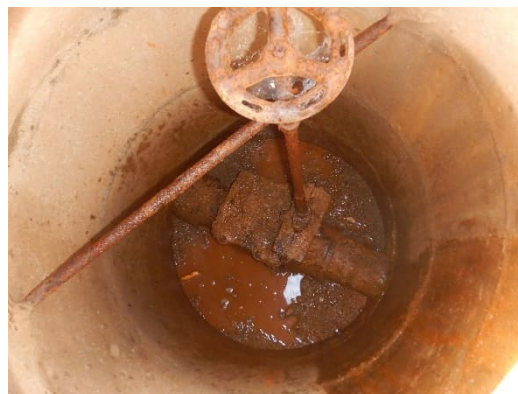
Kuva 29. Kaivot ovat betonirengaskaivoja, yhdessä kaivossa on valurautainen sulkuventtiili.
