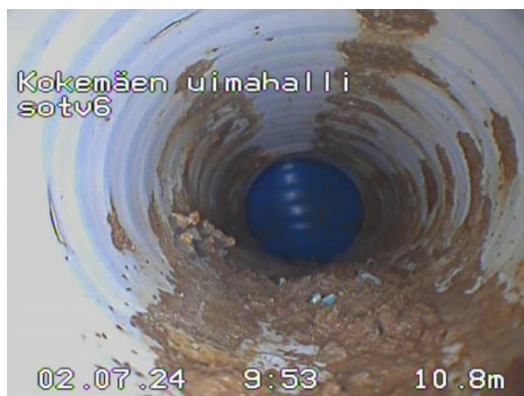
Kuva 30. Hieman lietettä salaojassa.
