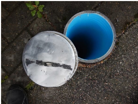
Kuva 45. Yleiskuva salaojakaivosta ja kannesta.
