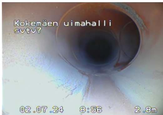
Kuva 21. Kellarista laskeva sadevesiviemäri, tasausaltaiden ylivuoto.
