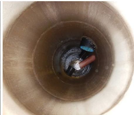
Kuva 40. Kaivo svtk5. Tähän laskee uimahallin suunnalta 3 viemäriä. Yksi viemäri tulee koulun suunnalta.
