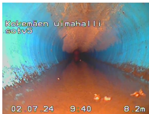
Kuva 29. Painuman aiheuttamaa vesitäyttöä viemärissä.
