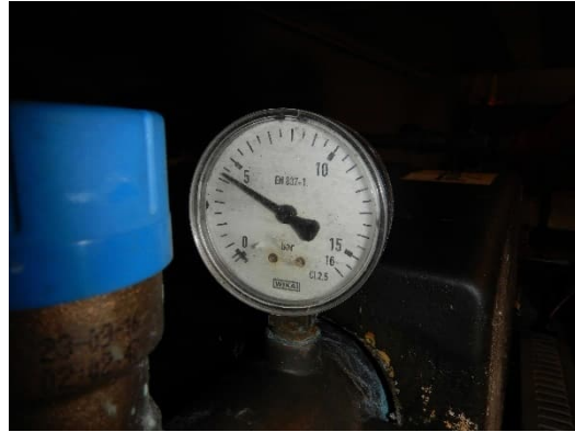
Kuva 16. Verkoston paine oli tarkastushetkellä n. 450 kPa.
