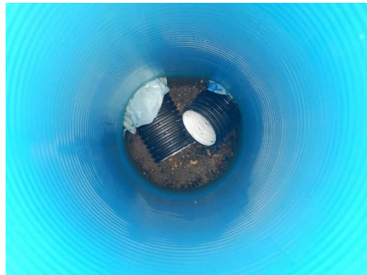
Kuva 46. Kaivot ja salaojat ovat muovia.
