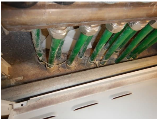
Kuva 11. Jakotukkikaapin pohjalla epätii- vis vuodonkeräysrakenne.
