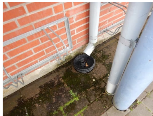
Kuva 42. Rännikaivoa ei saanut nostettua ylös, syöksytorvi edessä.
