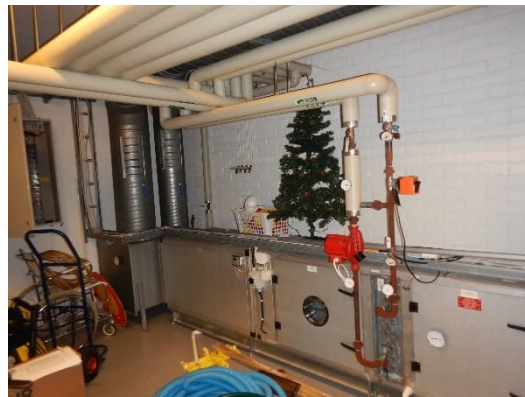
Kuva 6. Yleiskuva teknisen tilan lämmityspotkiasennuksista.
