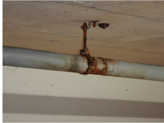
Kuva 34. Voimakasta korroosiota viemärin kannakkeessa.
