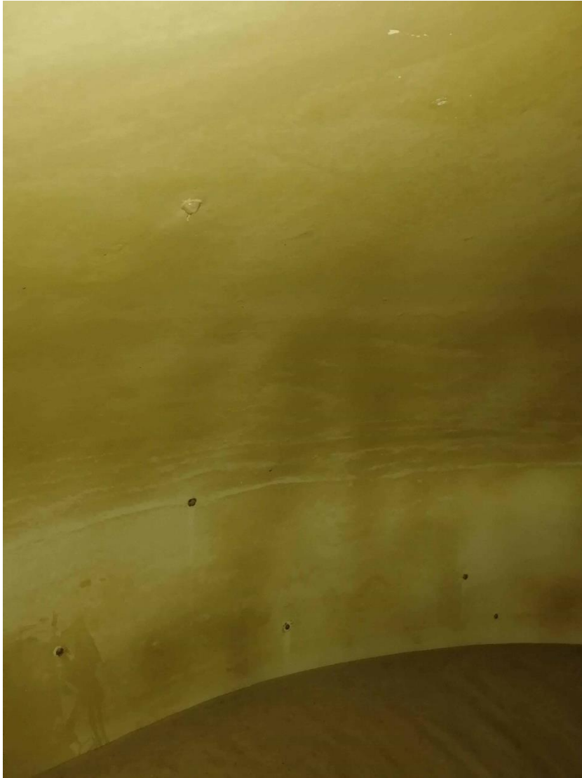
Suodatin 1 sisäpuolelta, kuvassa näkyy reikiä joista vesi pääsee suodattimen runkorakenteisiin
