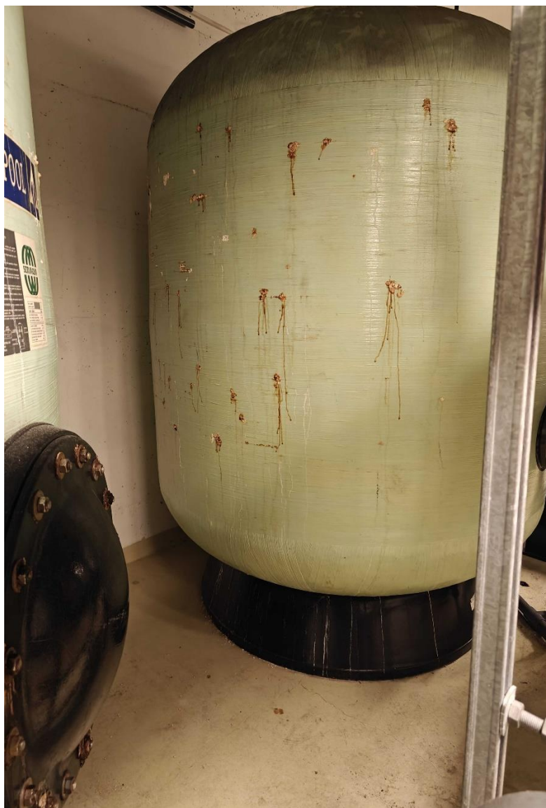
Suodatin 1 takapuolelta, siinä näkyy myös runsaasti vuotopaikkoja
