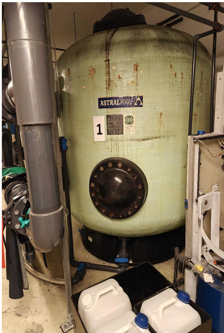
Suodatin 1 ulkopuolelta, kuvassa näkyvät vuotopaikat joista vesi on tullut ulos
